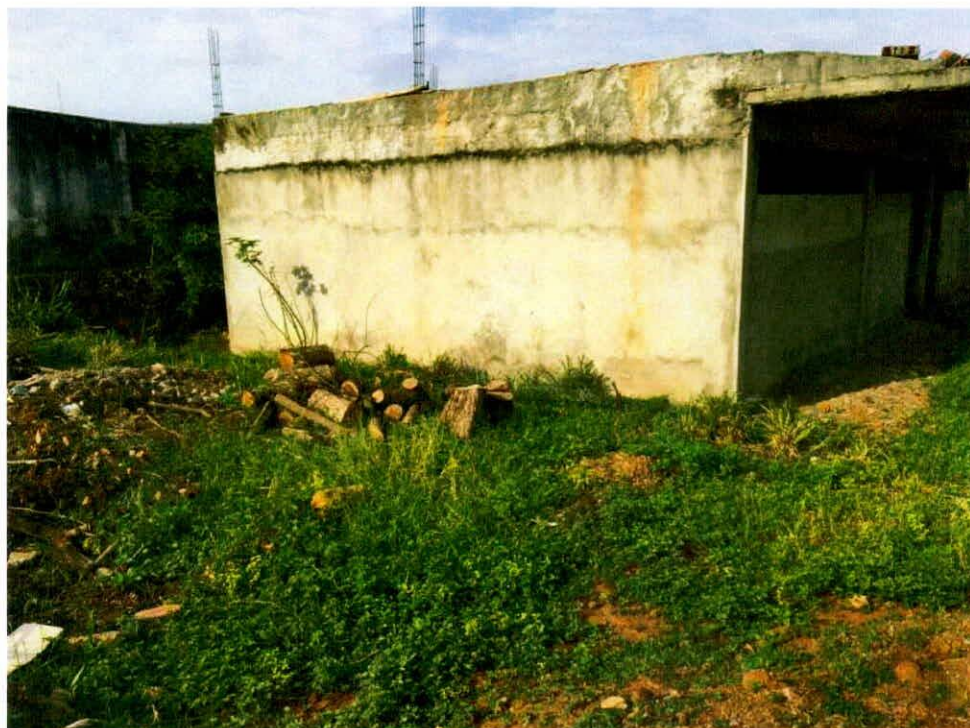
FOTOGRAFIA 53 - VISTA INTERNA CETEP VISTA MÓDULOS INACABADOS
