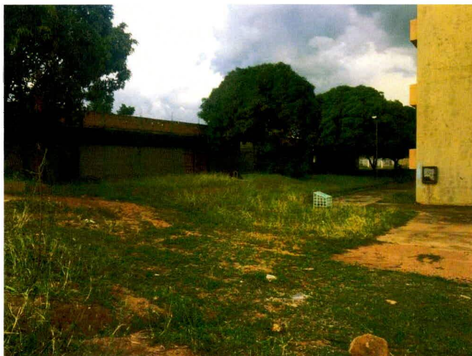
FOTOGRAFIA 48 - VISTA INTERNA CETEP VISTA FUNDOS, MÓDULOS INACABADOS
