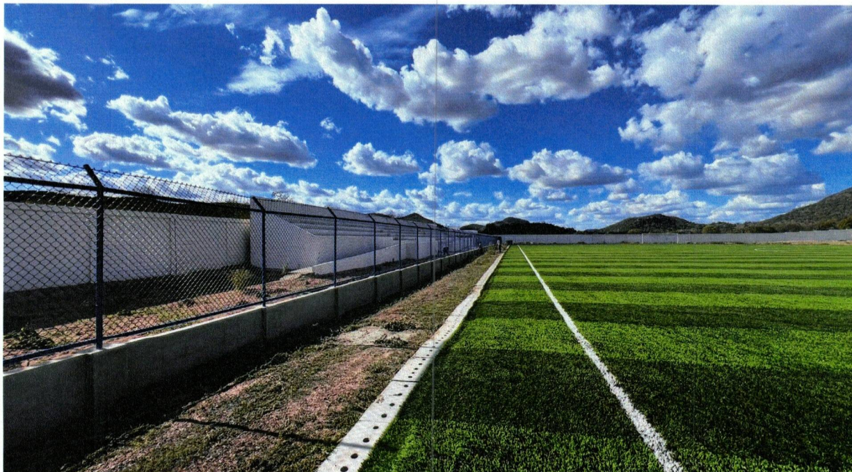
FOTO 02 - Vista do alambrado e mureta de base, Observa-se a pendência de instalação do cabo de aço na parte superior de toda a extensão do alambrado. mureta pendente pintura e acabamento final.
