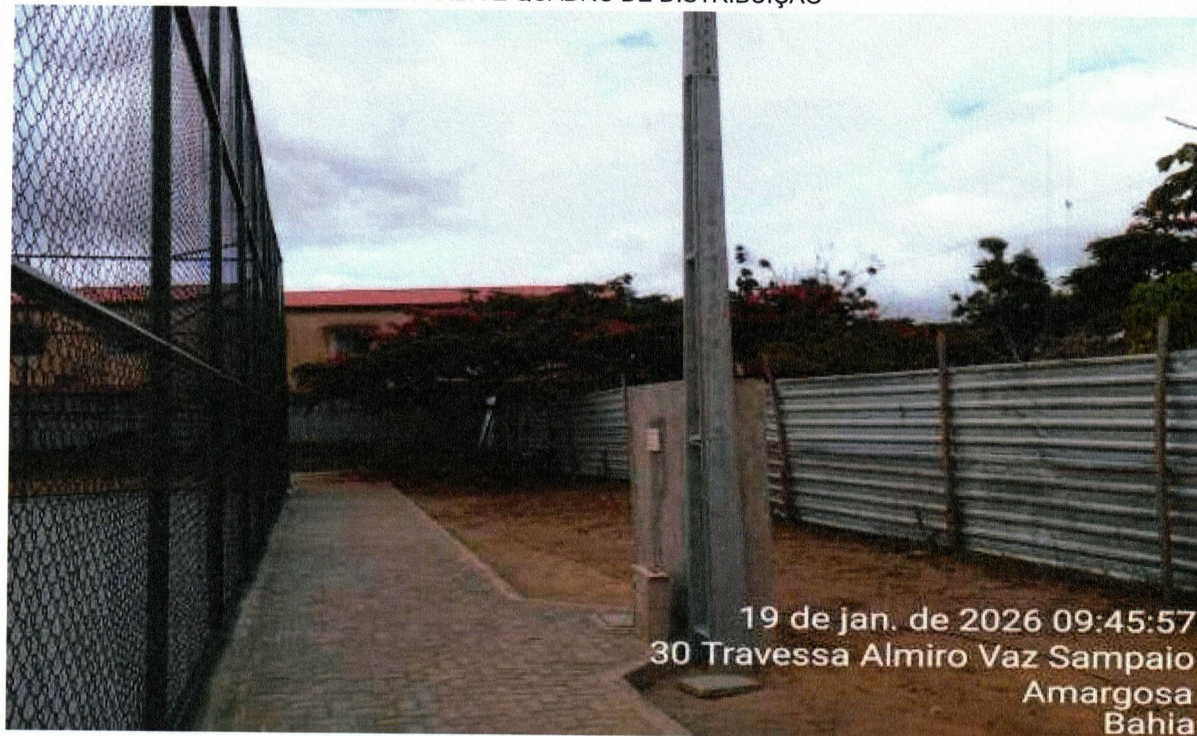
FOTO 03- VISTA DO PADRÃO DE ENTRADA E QUADRO DE DISTRIBUIÇÃO
