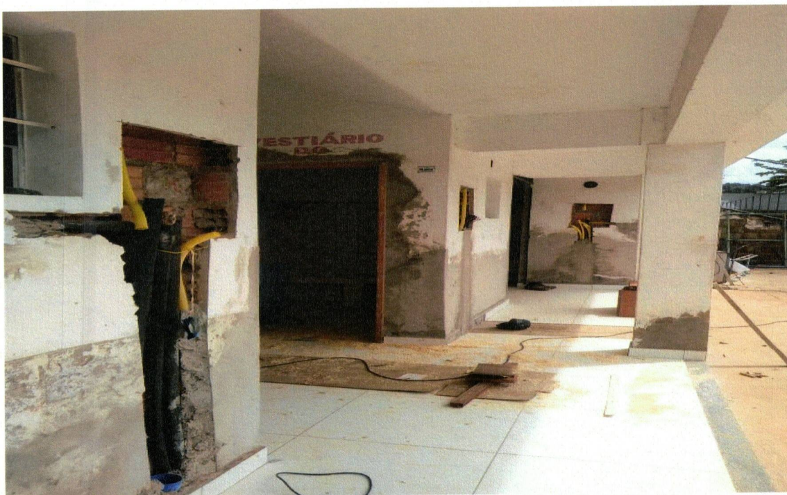
Foto 06 – Instalações Elétricas do Estádio Municipal Mário Muniz Monteiro
