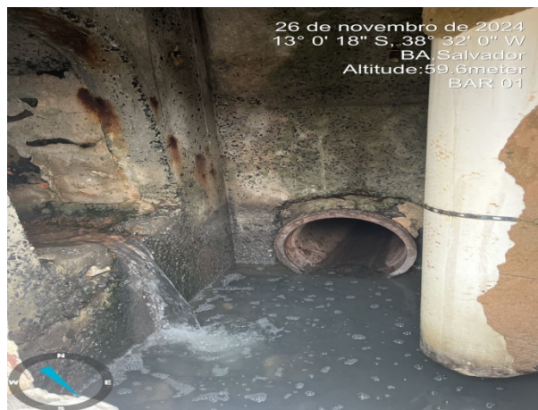
Figura 53. Ponto BAR 01, situado na Captação de Tempo Seco da Embasa próximo ao Forte Santa Maria/Barra.
