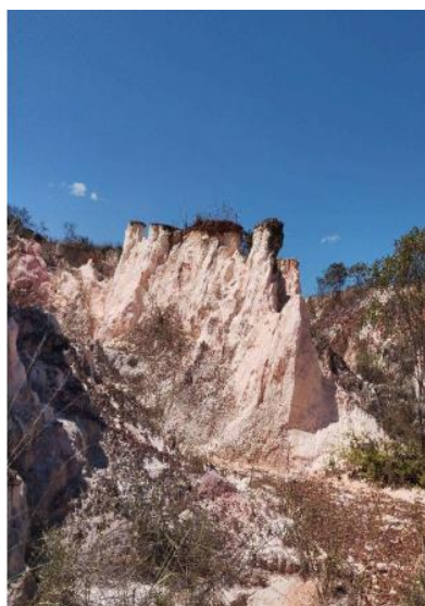
Figura 1c – Área de degradação com taludes verticalizados, com alturas da ordem de 5,0 m.
