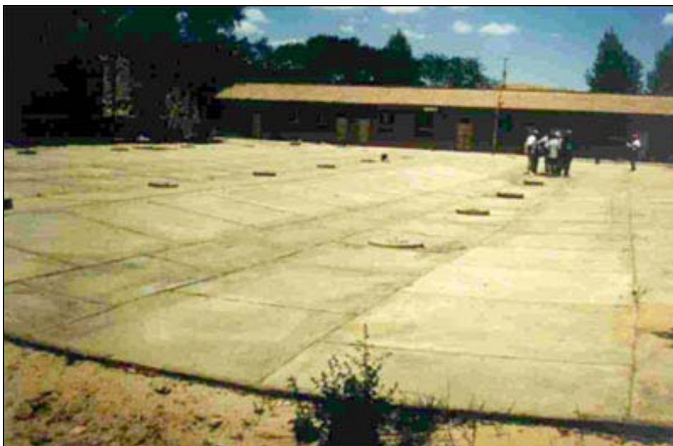
Figura 3.2.5.4 - Vista parcial de sistema de colheita de água de chuva em superfícies revestidas e telhados.
