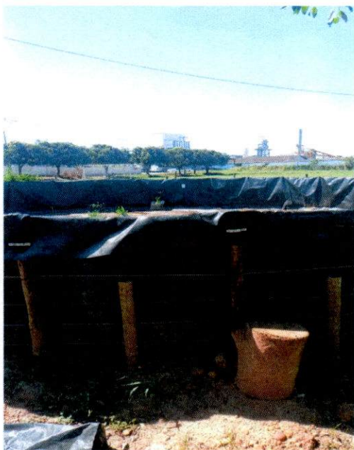
Sistema de captação de água da chuva
