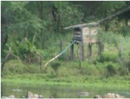
Figura 8.2.19: Bomba de água na margem esquerda do rio, à jusante do ponto CON-CON-500 – Rio de Contas
