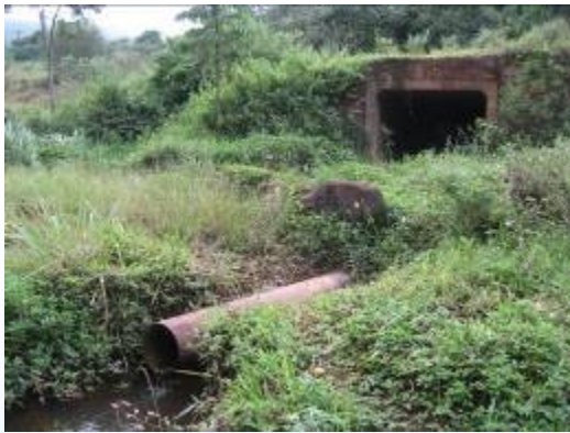
Figura 8.2.17: Lançamento de efluente no ponto ITP-AIP-050 - Rio Aipim
