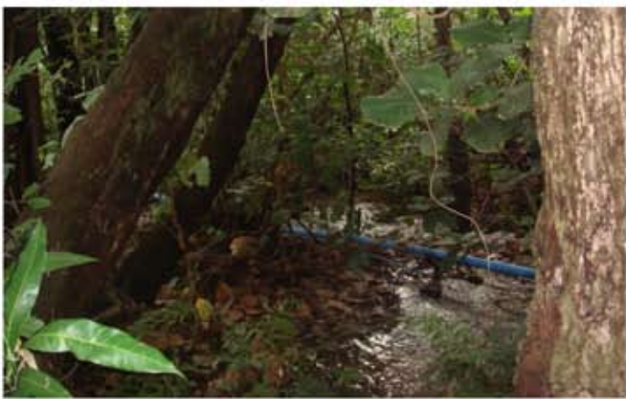
FOTO 155 – Cano do bombeamento d’água
