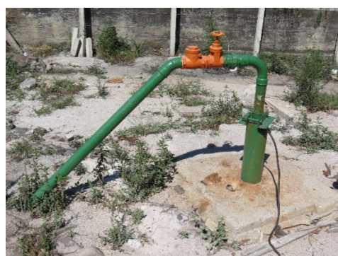
Foto 3.12 - Poço Tubular utilizado para abastecimento em Ipupiara
