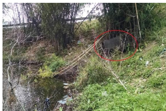
Figura 14: Conduto de drenagem de água pluvial encontrado na Lagoa Jorge Amado.
