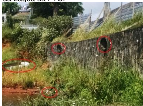
Figura 23: Conduto de drenagem de escoamento de água pluvial no entorno da Lagoa da FTC.
