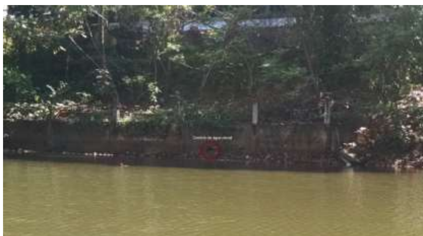
Figura 44: Conduto de água pluvial.
