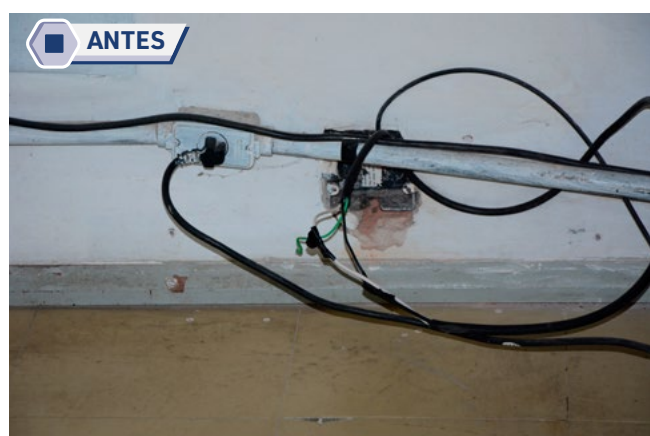
Instalações elétricas e lógica em 2016
