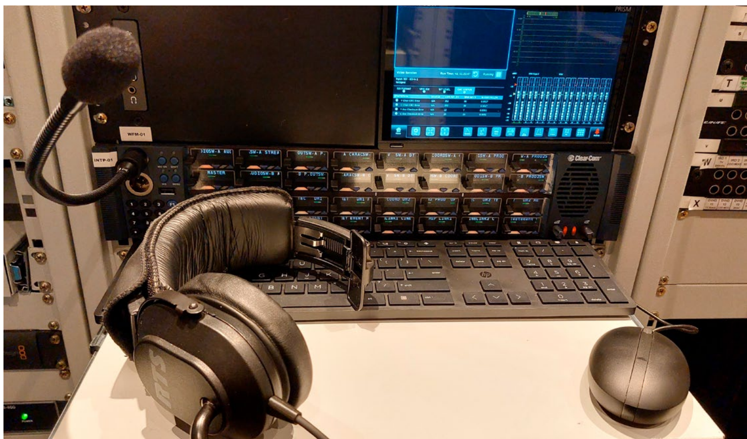
Sistema de intercomunicação em 2022
