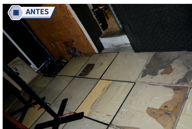
Instalações elétricas e lógica em 2016
