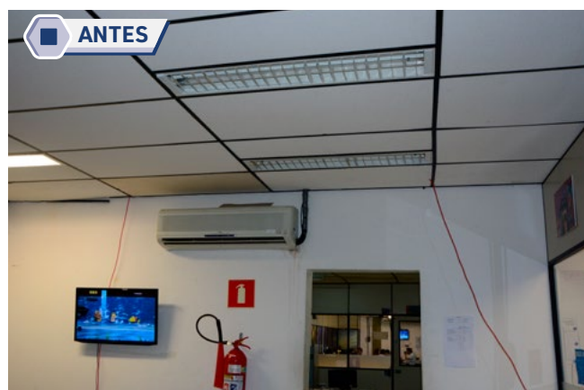
Instalações elétricas e lógica em 2016
