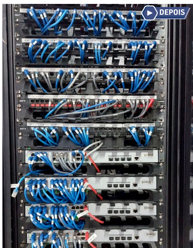
Instalações elétricas e lógica em 2022
