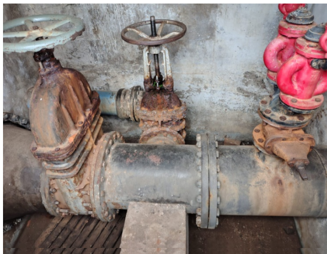
Válvulas das captações do DIRFAV e da Bahia Pesca nas instalações da Barragem UHE Pedra
