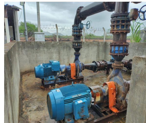
Bombas do sistema de captação da Largo Vanádio de Maracás
