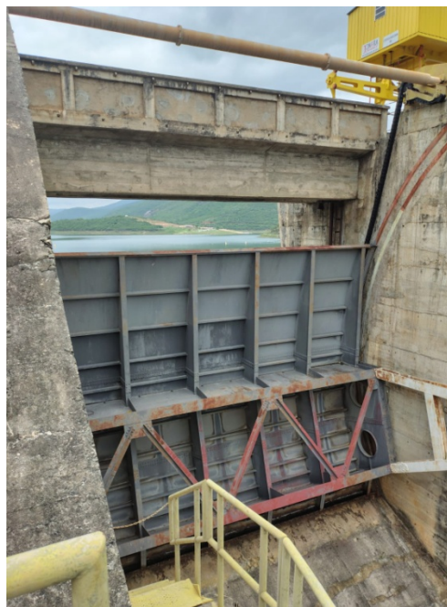
Comporta da Barragem UHE Pedra
