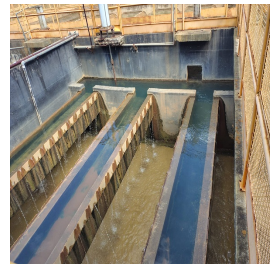
Filtros na Estação de Tratamento de Água da EMBASA em Jequié
