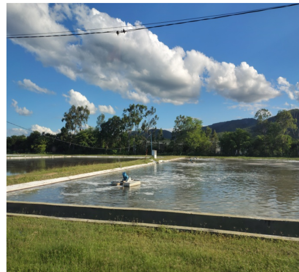
Lagoa de estabilização de efluentes na ETE de Jequié – EMBASA
