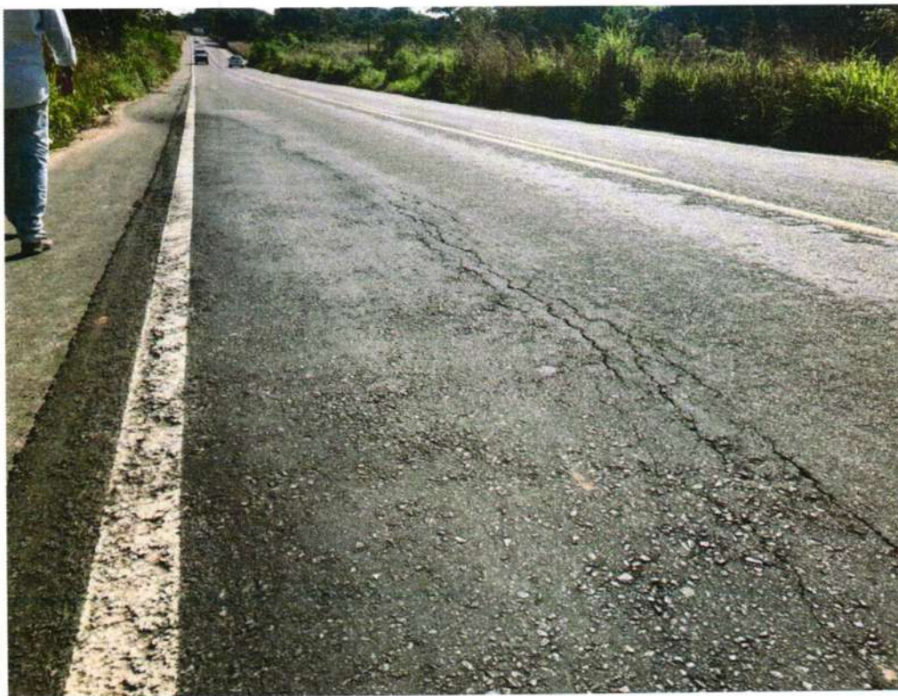
Trincas longitudinais na trilha de rodas
