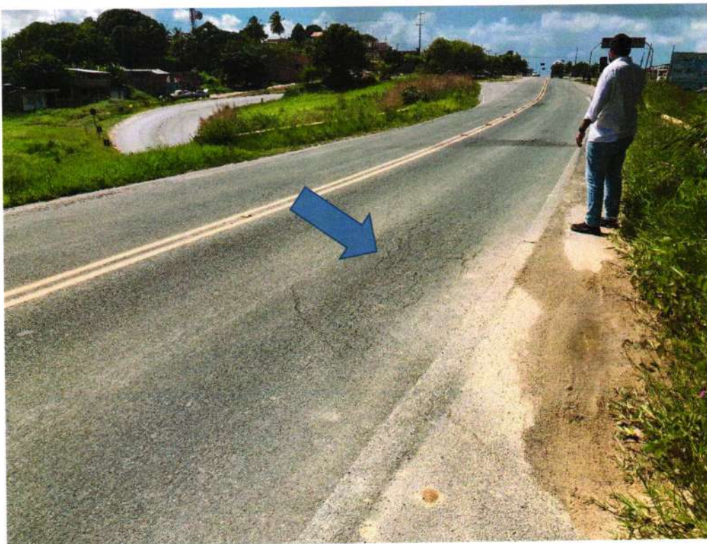
Trincas interligadas na pista sobre a passagem.
