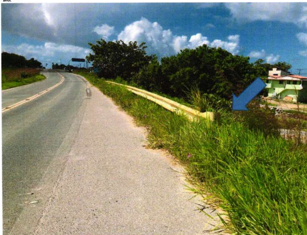
Terminal da defesa de entrada sem ancoragem
