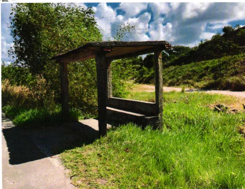
Abrigo fora de padrão em péssimo estado no Km 22,017
