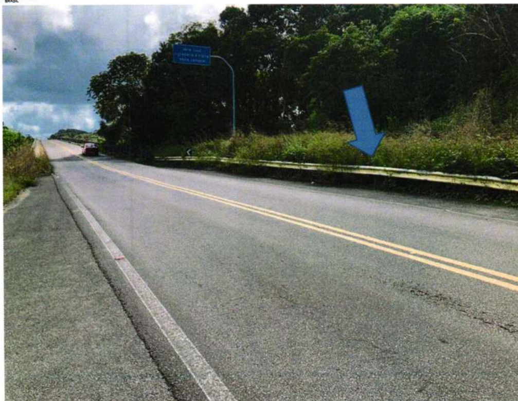
Terminal da defesa de entrada sem ancoragem
