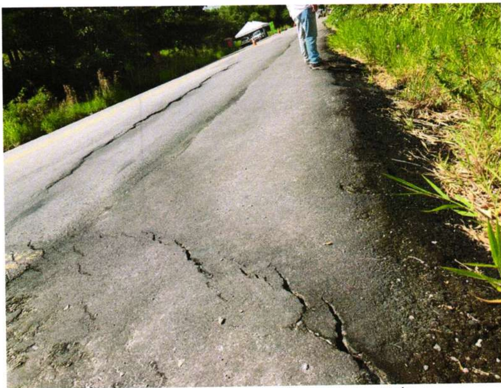
Fissuração avançada no perímetro do remendo.
