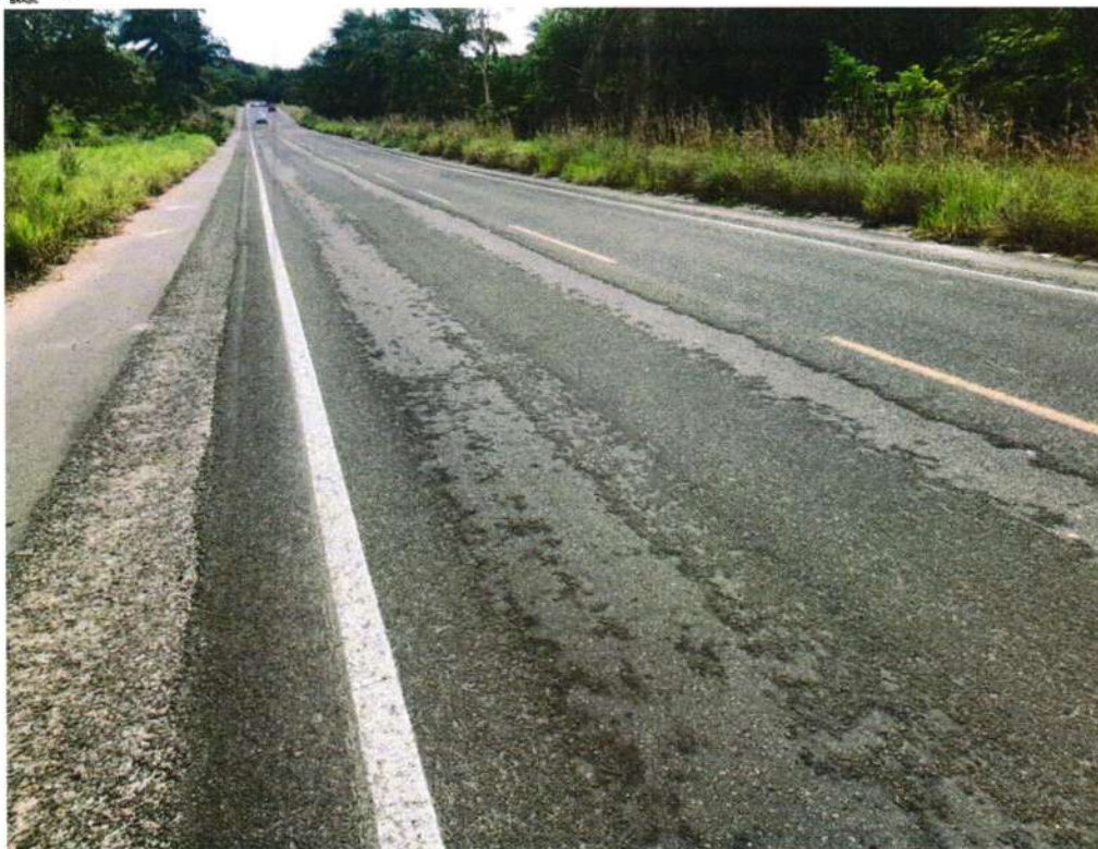
Desgaste superficial da camada de CBUQ, característico do trecho de aclive.
