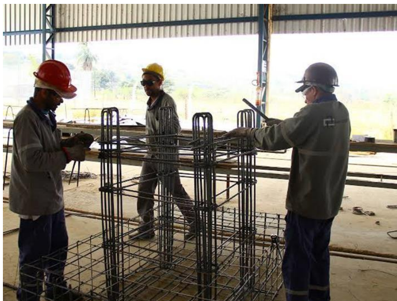
Figura 13 – Vista parcial de Central de Armação
