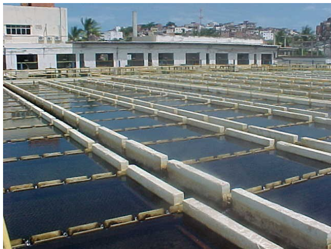
Figura 1 - Estação de Tratamento da Água
