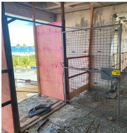
Barreira (cancela) da torre do elevador sem dispositivo de segurança para impedir sua abertura quando o elevador não estiver no nível do pavimento.
