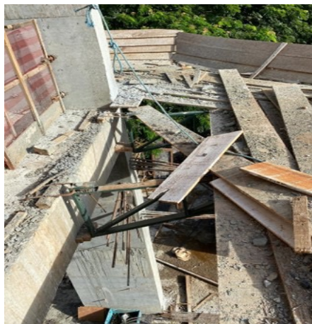
Plataforma de proteção secundária ("bandeja secundária") sem forração completa, sem manutenção e com acúmulo de materiais
