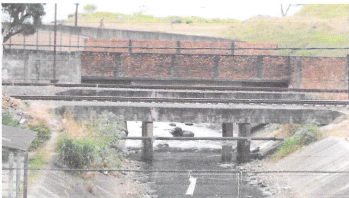
Figura 60 - Comprometimento do Rio Paraguari.
