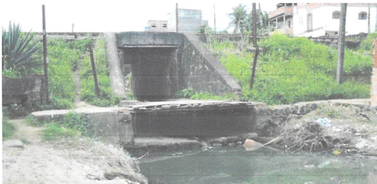
Figura 162- Piso da passagem danificado.
