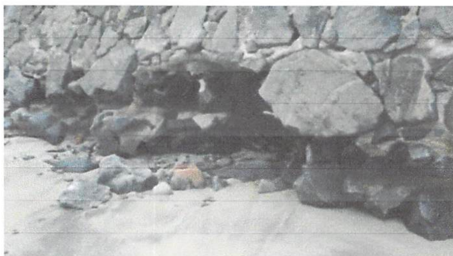
Figura 148 - Solapamento da base do muro.
