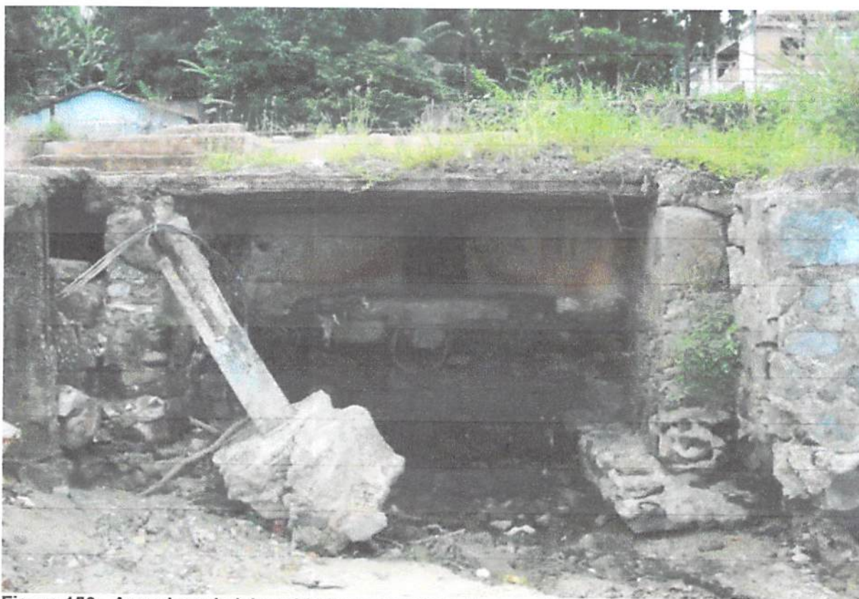
Figura 159 - Armadura da laje oxidada e encontros descalçados.
