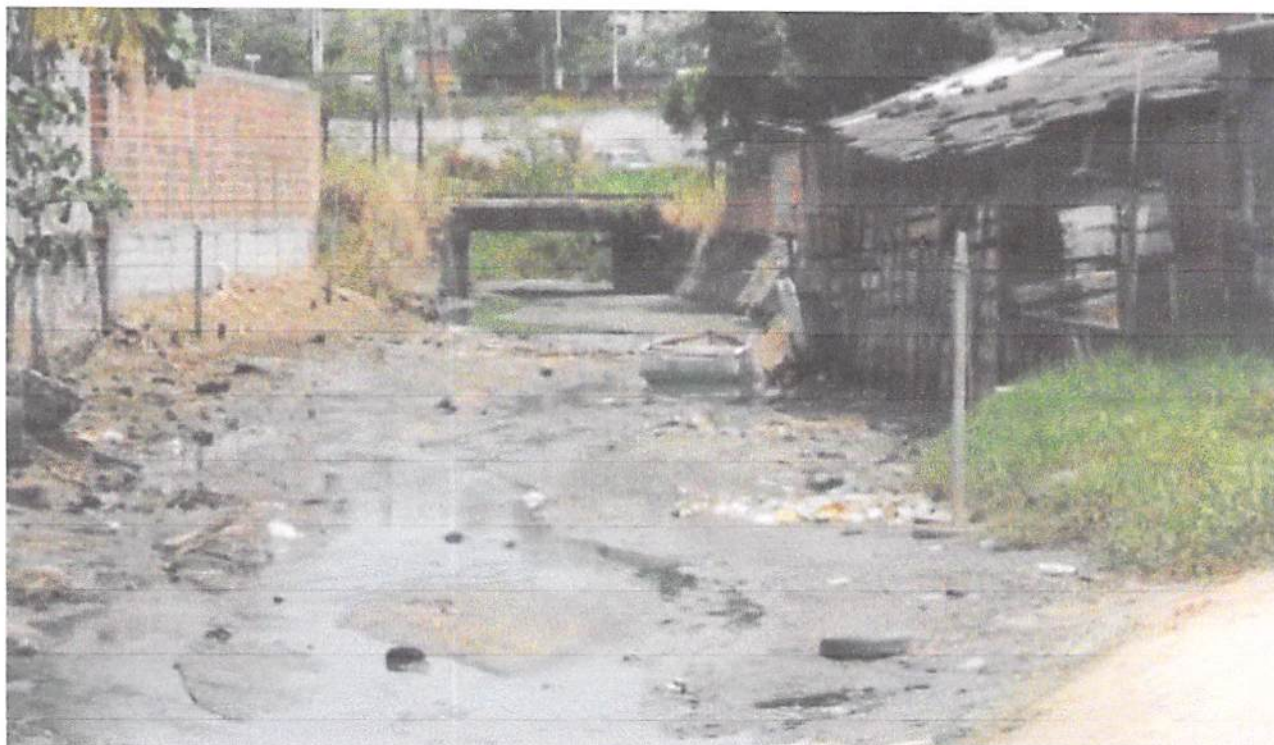
Figura 67 - Acúmulo de lixo no riacho Paripe e na foz do rio Paraguari.
