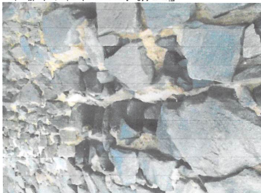
Figura 149 - Argamassa de rejunte danificada.
