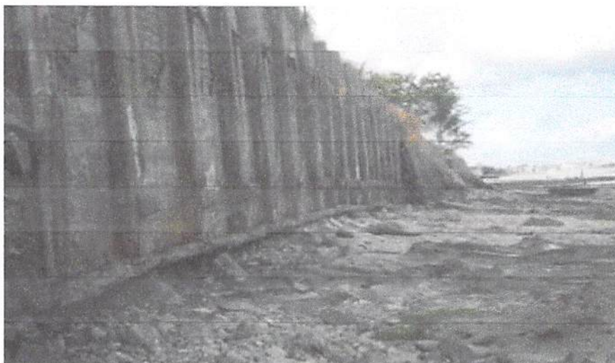
Figura 153- Solapamento da base do muro.
