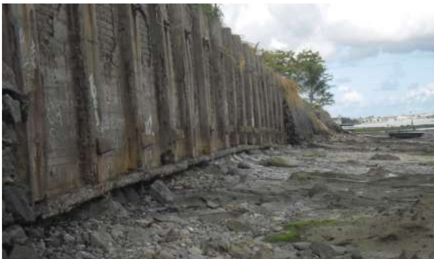
Figura 153- Solapamento da base do muro.
