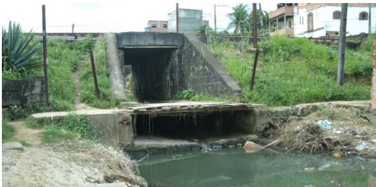
Figura 162- Piso da passagem danificado.
