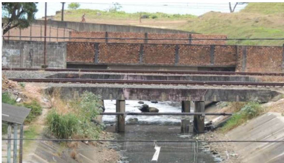
Figura 60 - Comprometimento do Rio Paraguari.
