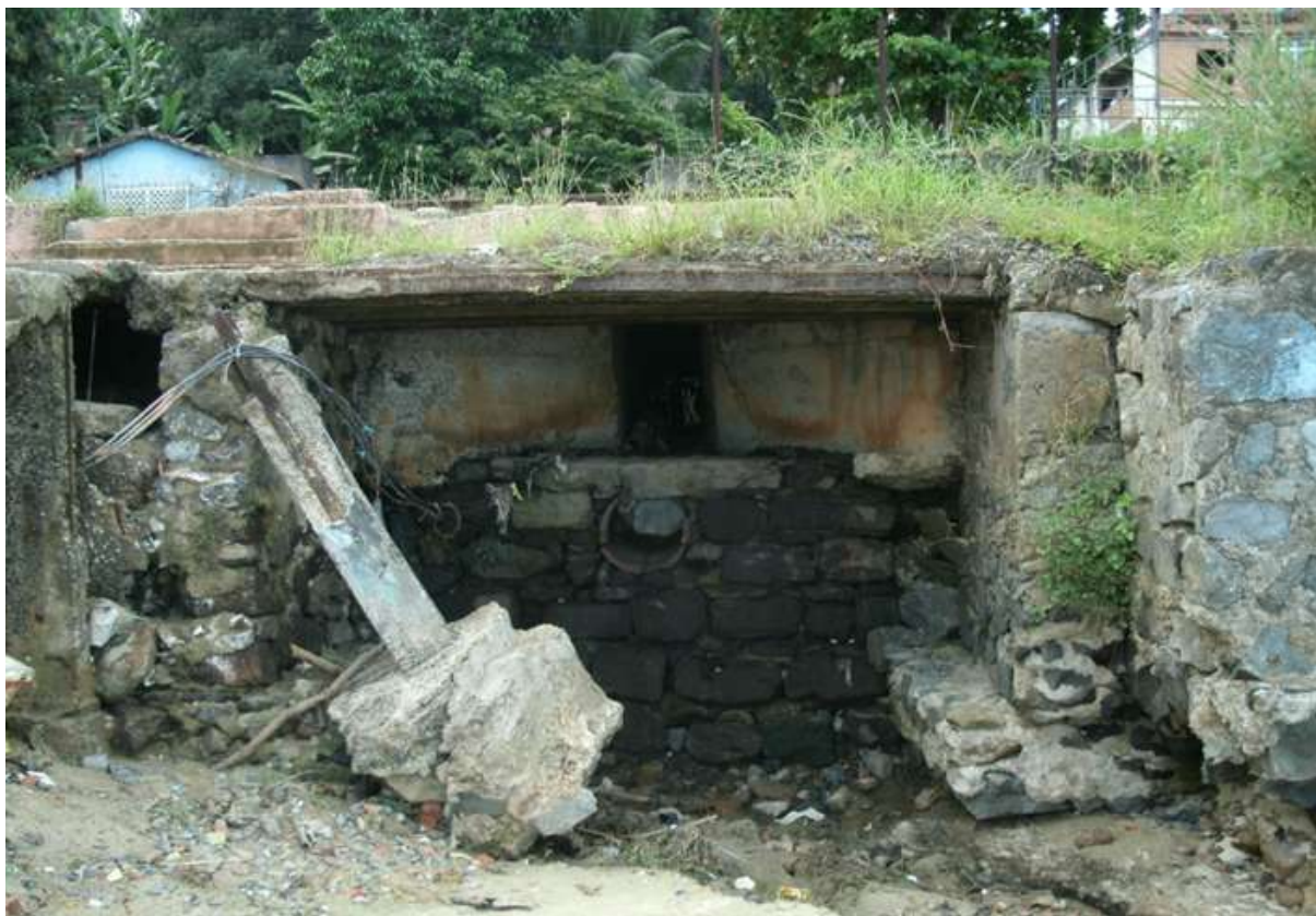
Figura 159 - Armadura da laje oxidada e encontros descalçados.
