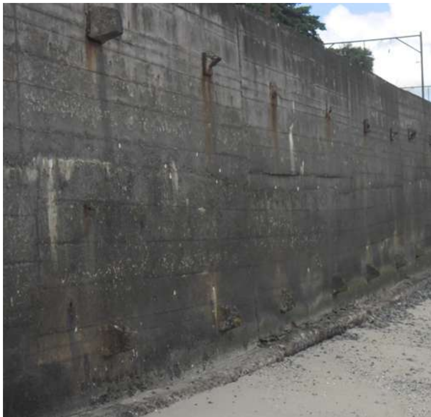
Figura 151 - Muro atirantado (altura variando entre 5,0 e 8,0m).
