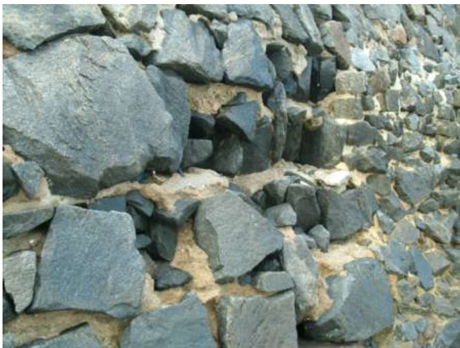
Figura 149 - Argamassa de rejunte danificada.
