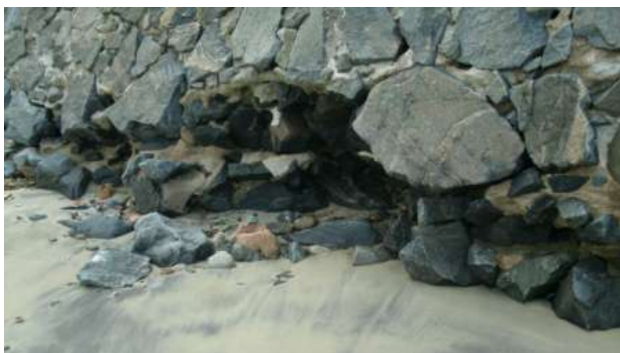
Figura 148 - Solapamento da base do muro.
