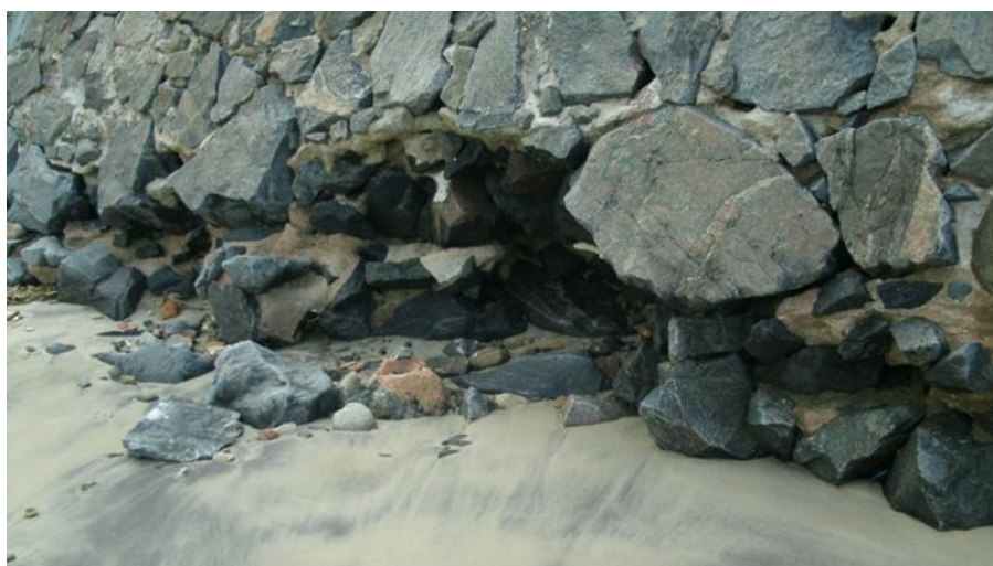
Figura 148 - Solapamento da base do muro.
