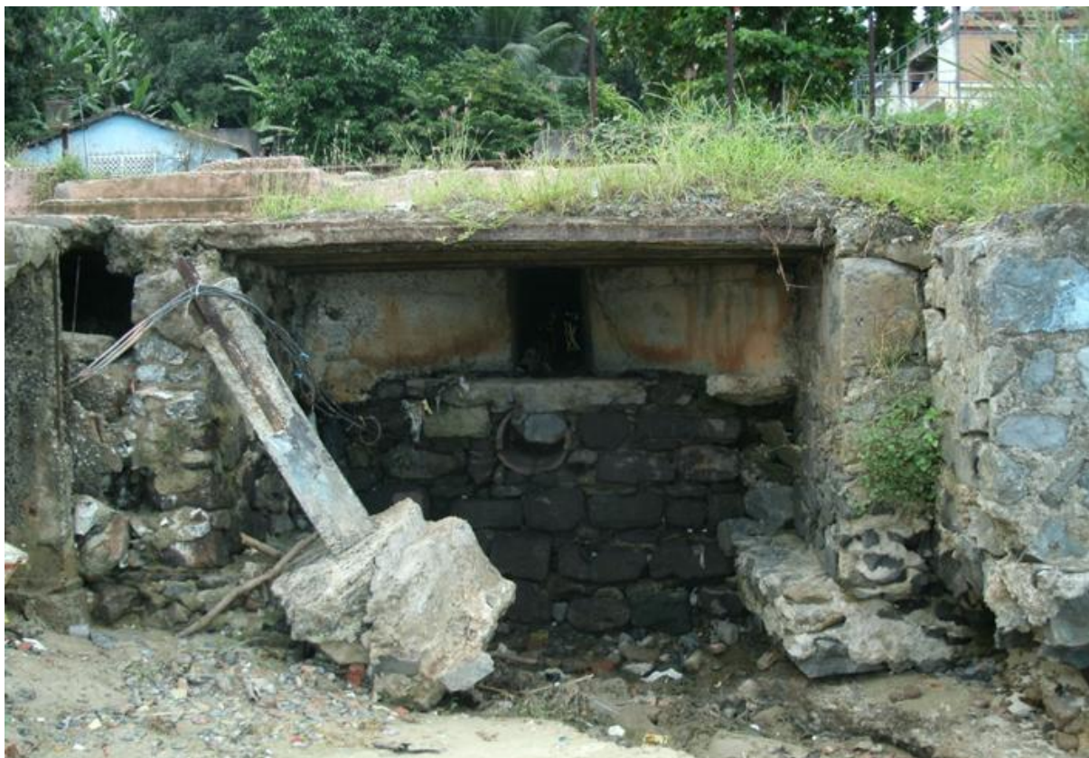
Figura 159 - Armadura da laje oxidada e encontros descalçados.
