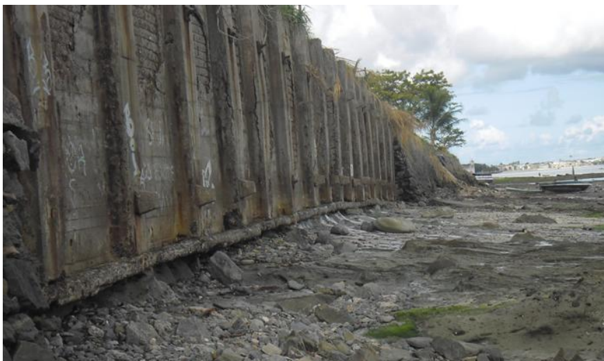
Figura 153- Solapamento da base do muro.
