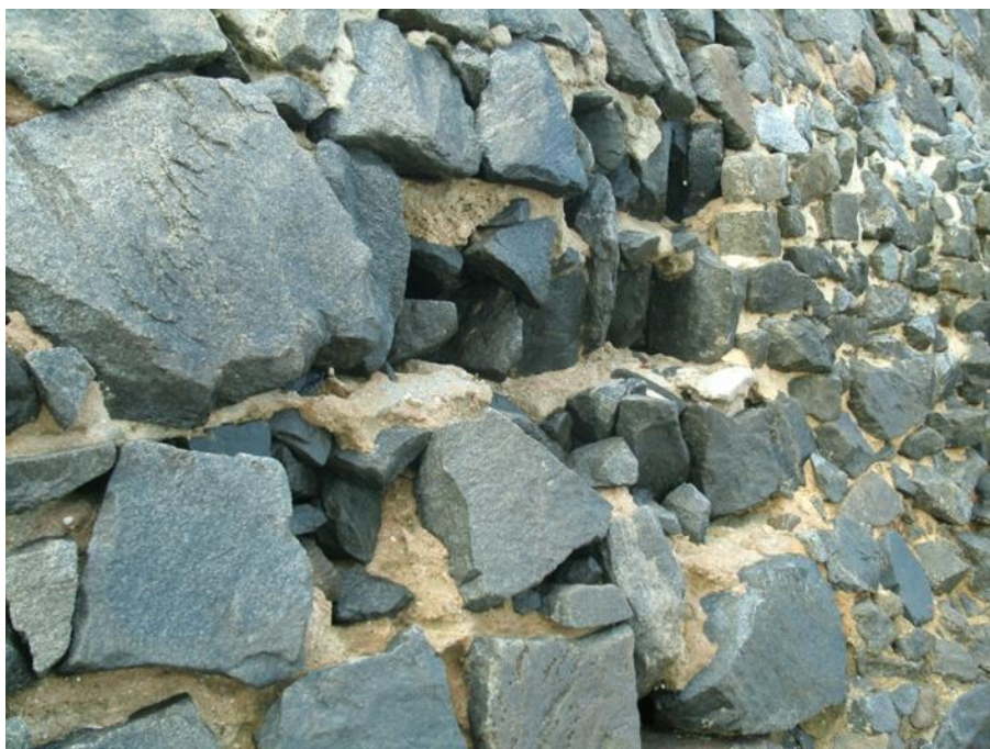
Figura 149 - Argamassa de rejunte danificada.
