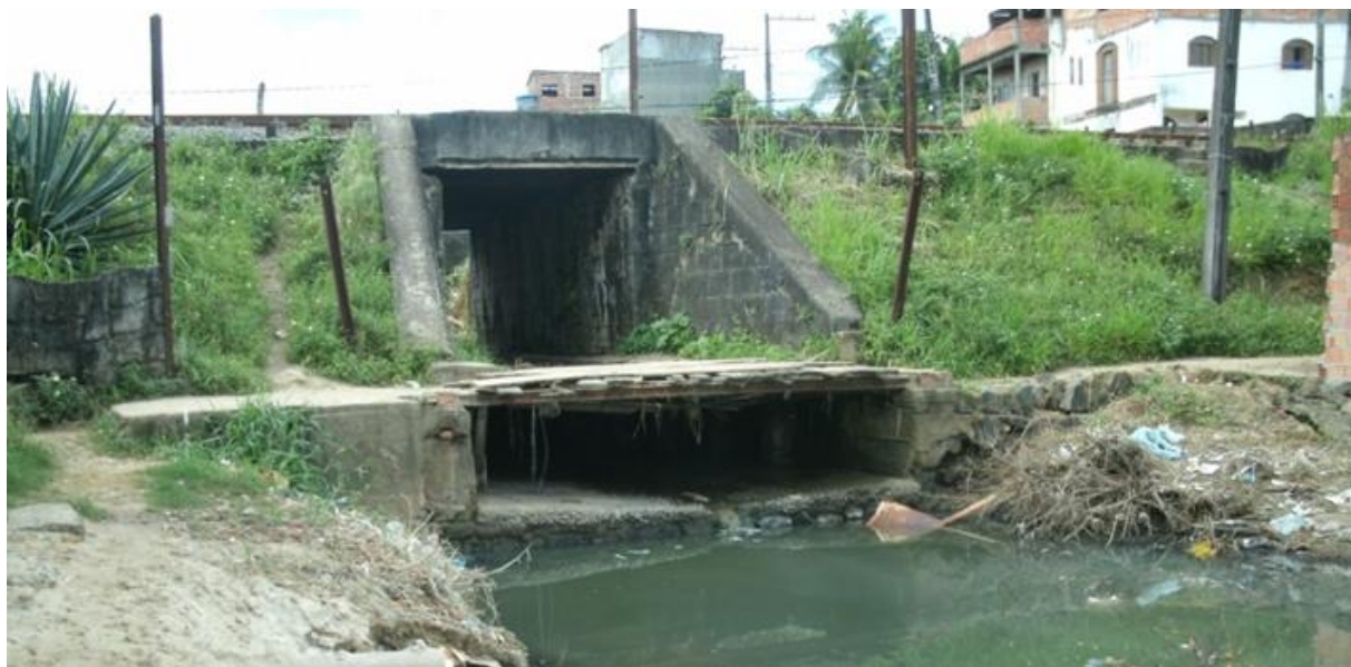
Figura 162- Piso da passagem danificado.
