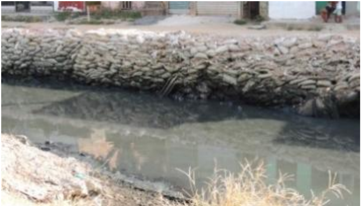
Figura 64 - Aterro e lançamento de resíduos sólidos em corpos d'água e na área de influência da maré.
