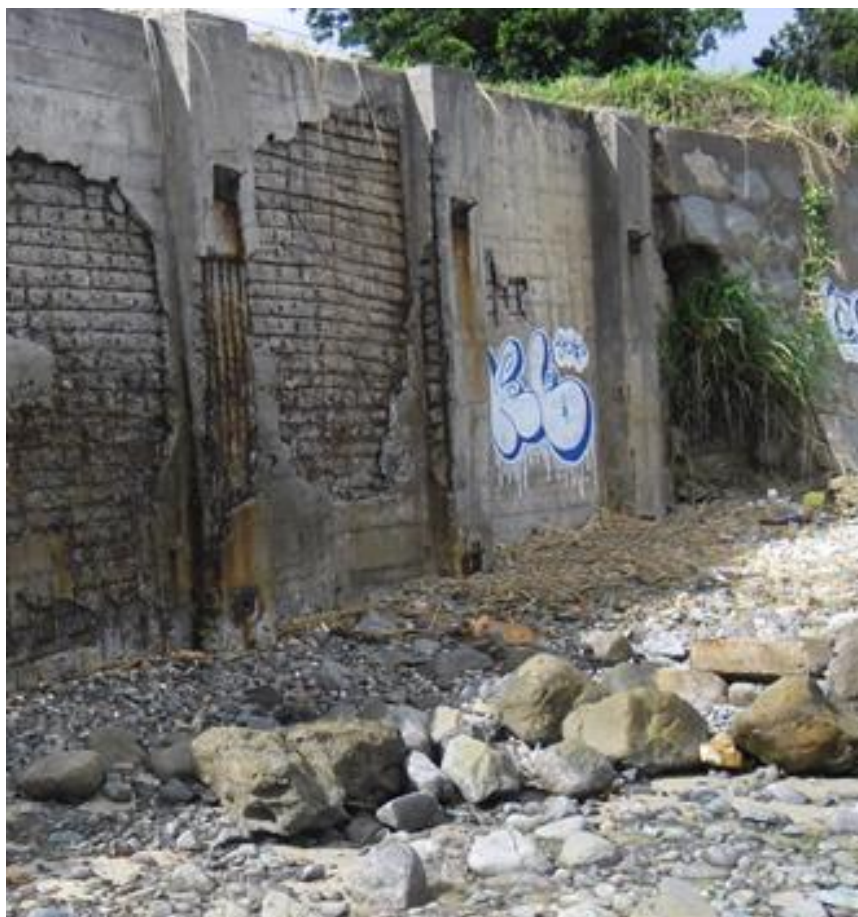
Figura 155 - Armaduras da parede entre contrafortes e dos contrafortes oxidadas.
