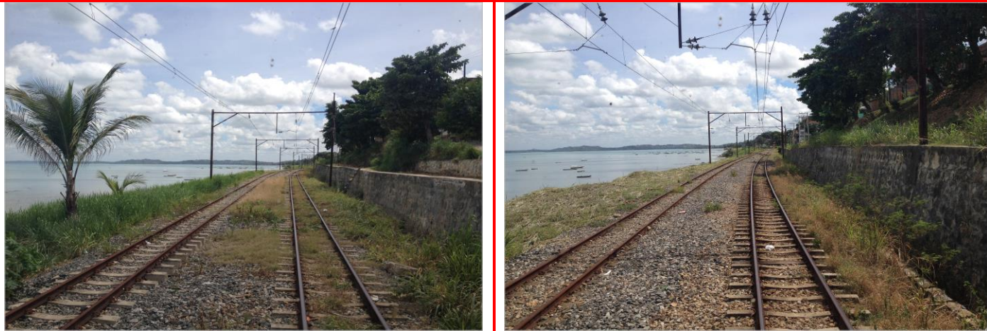
Recomenda-se além da solução do problema do escorregamento, a implantação de um dreno profundo ao longo de toda a encosta e a limpeza total das valetas e bueiros, recuperando aqueles danificados e construindo novos dispositivos drenantes complementares
