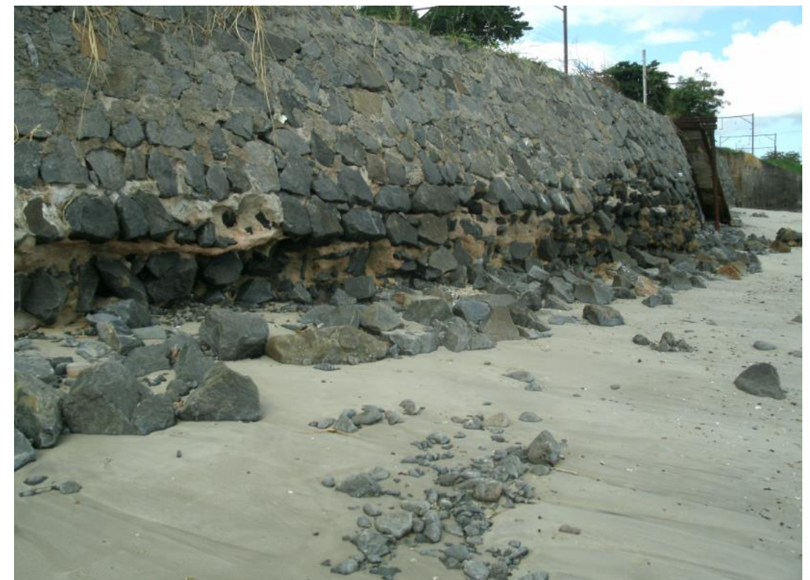
Solapamento da base do muro
