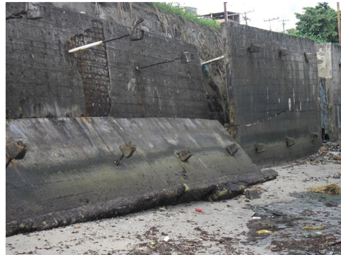
Muro atirantado colapsado
