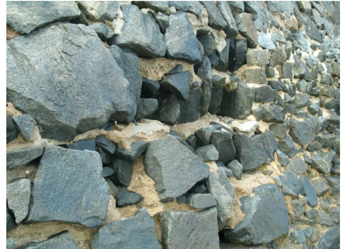
Argamassa de rejunte danificada
