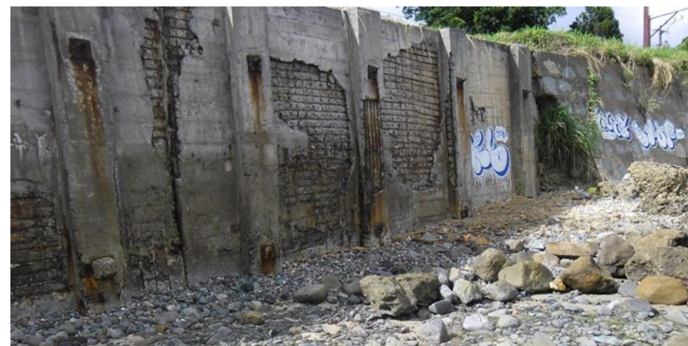
Armaduras da contenção oxidadas
