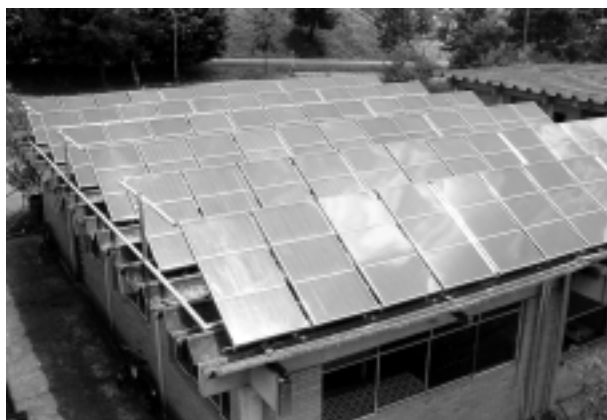
Figura 7 Sistema termossolar - Regap
