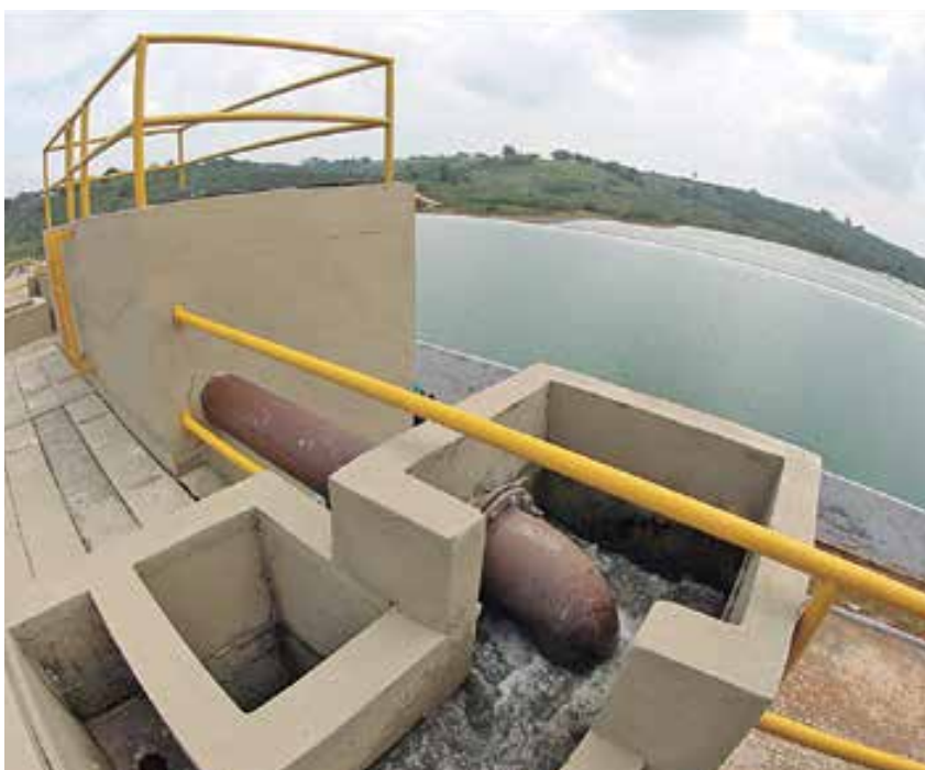
Sistema de Esgotamento Sanitário em Cruz das Almas
