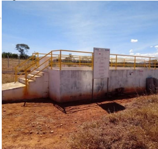
Figura 67 - Caixa de Areia ETE Caturama
