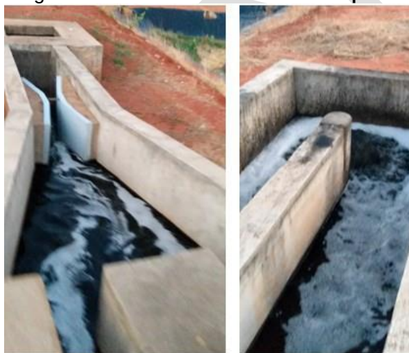
Figura 66 – Caixa de Areia – ETE Botuporã
