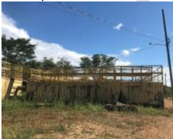
Figura 42 – ETA do Sistema Sede (São Desidério)
