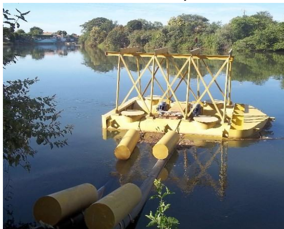
Figura 30 – Captação Rio Corrente (SAA SGPN Santana)
