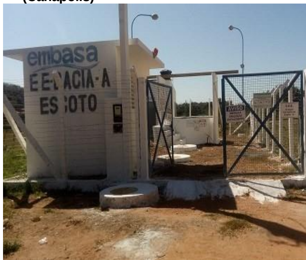
Figura 60 - EEE A do Sistema Sede (Canápolis)
