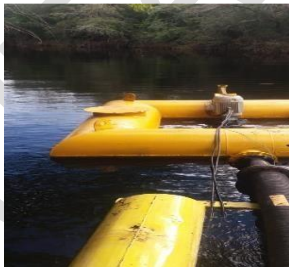
Figura 32 – Captação Iramaia Sede
