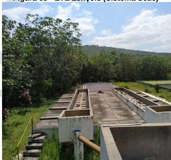
Figura 65 - ETE Lençóis (Sistema Sede)
