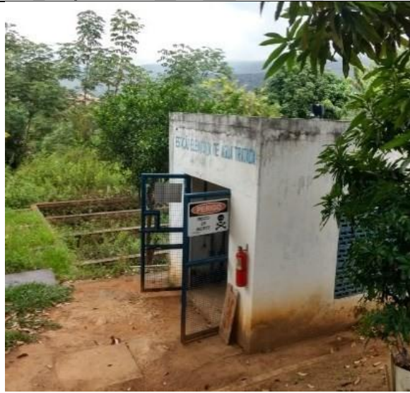
Figura 47 – EEAT (Sistema Sede – Andaraí)
