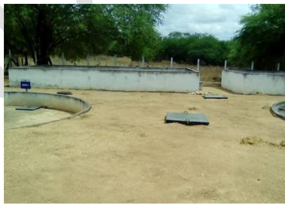
Figura 64 - ETE Ruy Barbosa (Sistema Sede)
