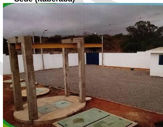
Figura 61 – EEE IT 02 do Sistema Sede (Itaberaba)
