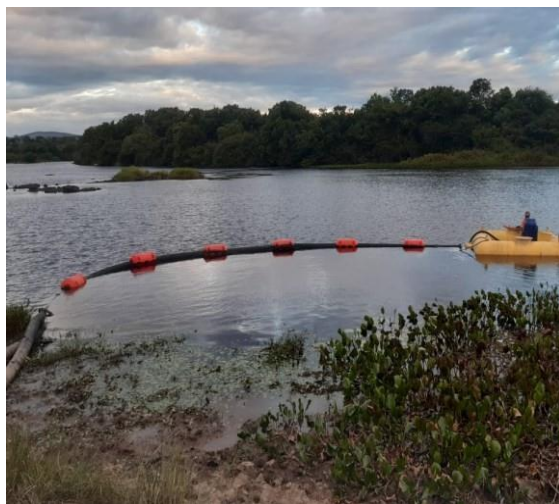
Figura 30 – Captação Boa Vista do Tupim SAA Sede
