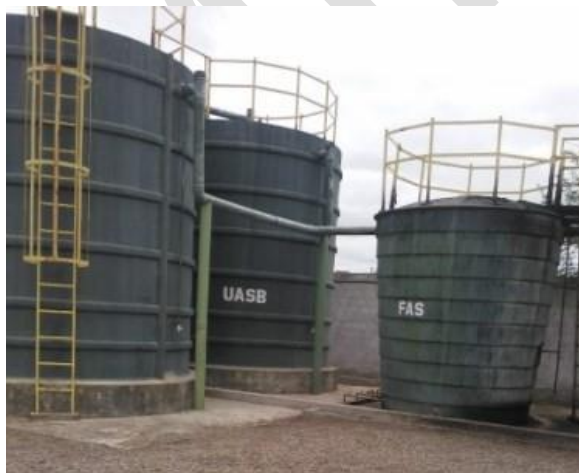
Figura 75 – ETE Cidade do Ouro do Sistema Sede (Jacobina)
