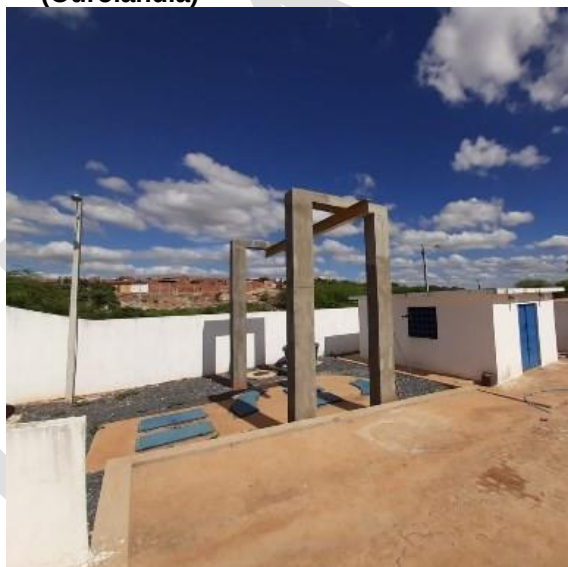
Figura 73 – EEE do Sistema Sede (Ourolândia)
