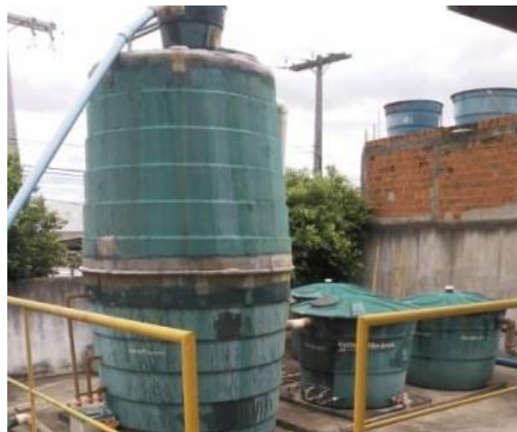
Figura 76 - ETE Golden Park do Sistema Sede (Jacobina)
