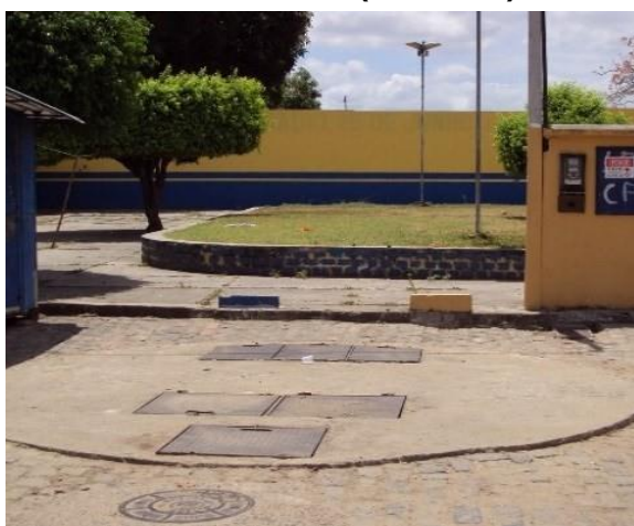
Figura 63 – EEE 03 do Sistema Sede (Cachoeira)
