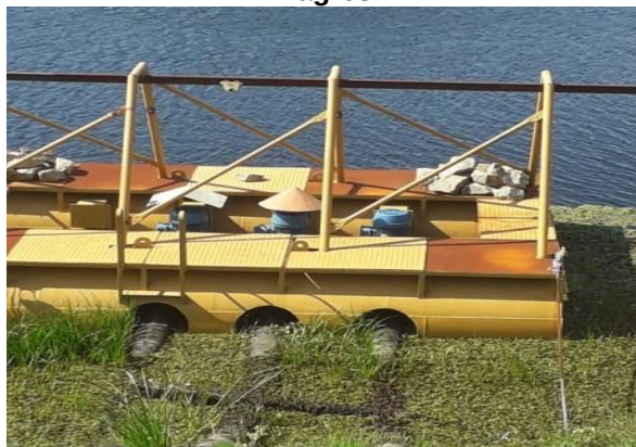
Figura 32 – Flutuante Captação Paraguaçu Milagres
