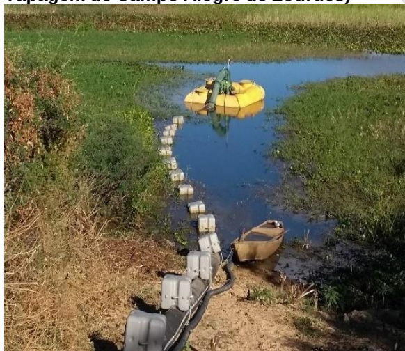
Figura 31 – Captação Flutuante Lago Sobradinho (Sistema Sede, Angico e Tapagem de Campo Alegre de Lourdes)
