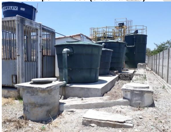
Figura 64 - ETE Vila das Esmeraldas – Campo Formoso (Sistema Sede)
