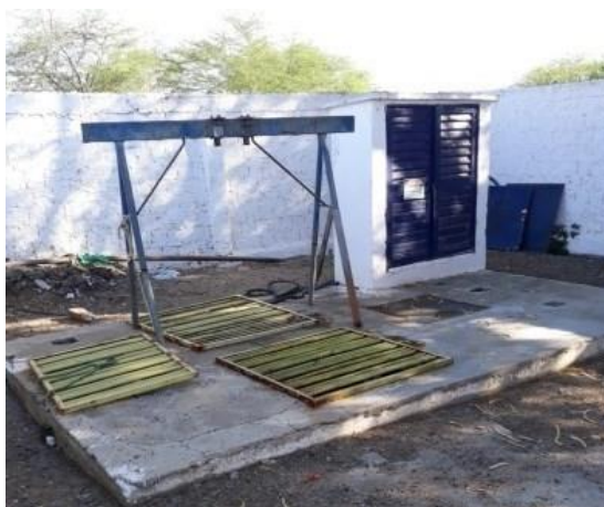
Figura 61 – EEE Quipá – Jaraguari (Sistema Pilar)
