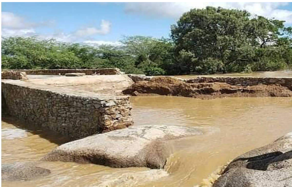
Figura 7 – Rompimento de Barragem em Pedro Alexandre
