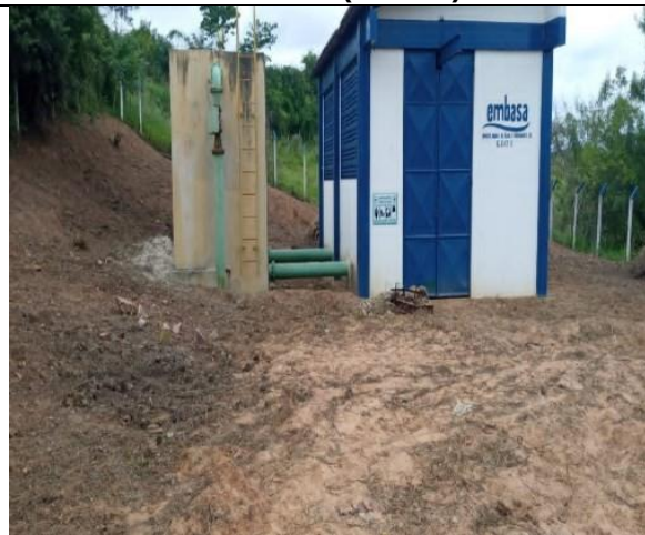
Figura 65 – EEAT do Sistema Sede, Andaraí e Sumaré (Piritiba)
