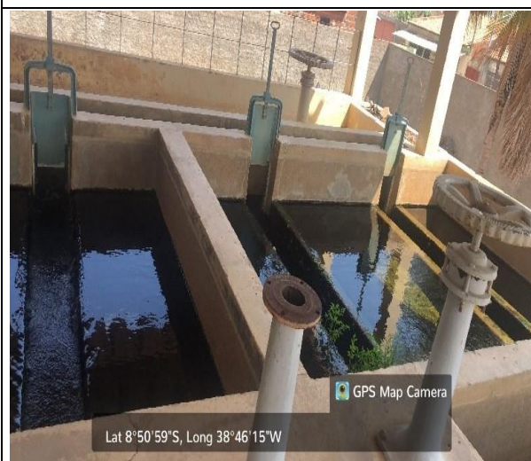
Figura 63 – ETA do Sistema Sede de Rodelas
