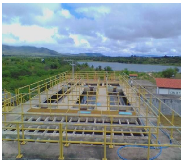
Figura 66 – ETA do Sistema Sede de Glória
