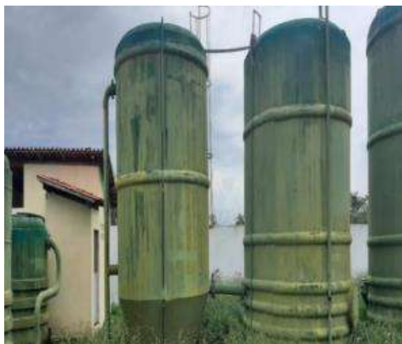
Figura 91 – ETE do Sistema Sede (Araci)
