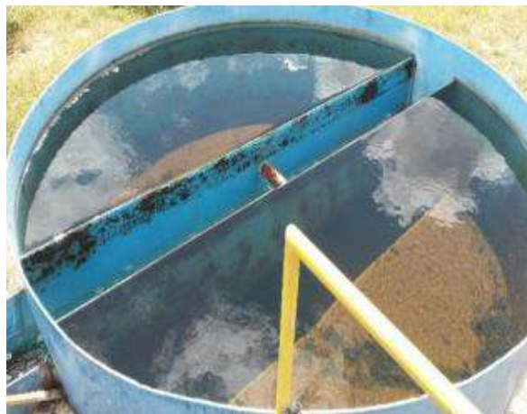
Figura 63 – Filtro de Aço ETA do SIA João Velho (Ipirá)
