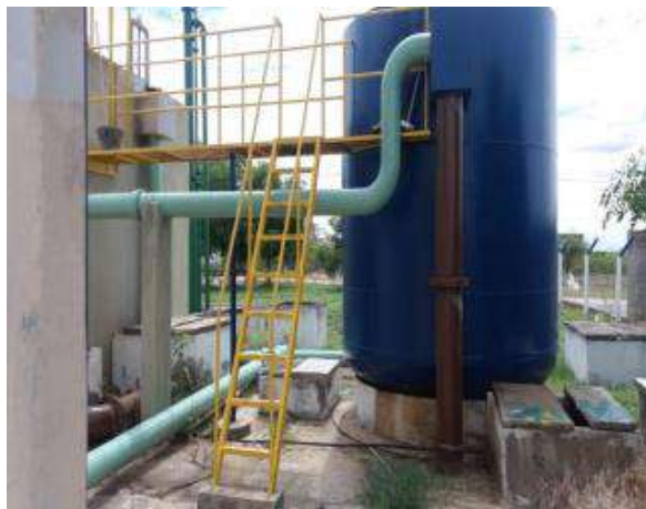
Figura 62 – Filtros do Sistema SCOV (São Domingos)
