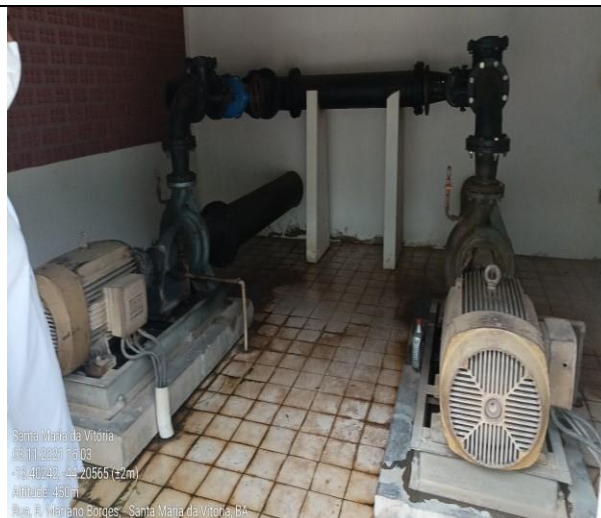
Figura 66 – EEAT do Sistema Sede de Santa Maria da Vitória
