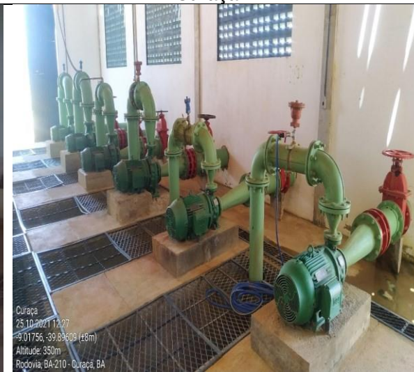
Figura 67– EEAT do Sistema Sede de Curaçá
