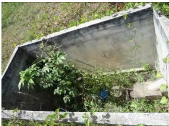
Figura 2.70 – Caixa de registro descoberta e com vegetação desenvolvida no poço CSB4
