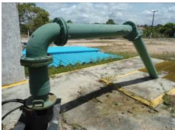
Figura 2.5 – Poço CSB1 localizado na área da ETA
