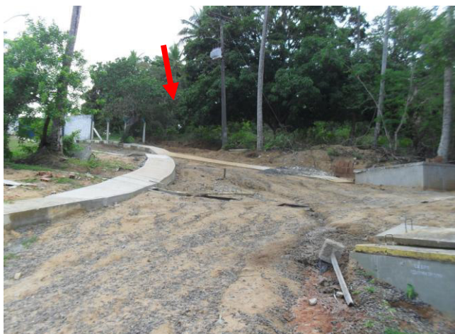
Figura 2.116 – Cerca danificada (detalhe em vermelho)
