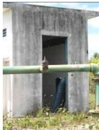
Figura 2.69 – Destaque para o abandono das instalações do poço CSB4
