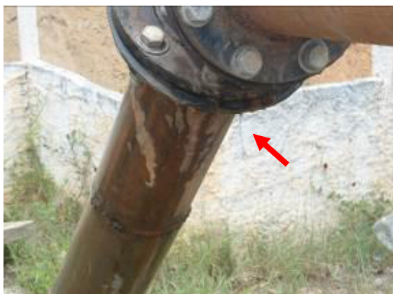
Figura 2.28 – Vazamento (em destaque) identificado no barrilete de recalque do poço Manteiga 2
