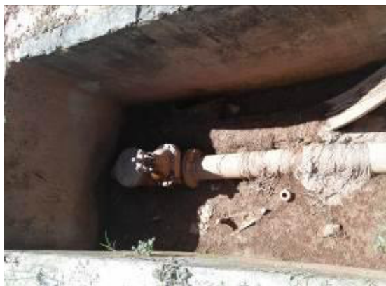
Figura 2.64 – Caixa de registro do poço CSB1, desprotegida
