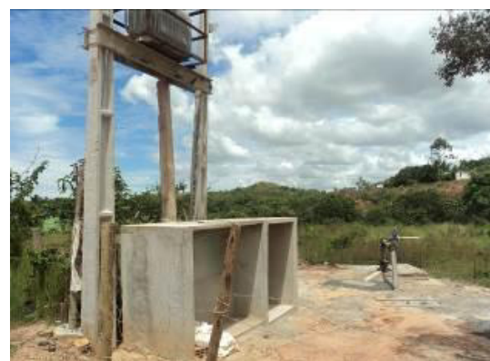
Figura 2.42 – Área do poço novo CSB9, estado precário das cercas
