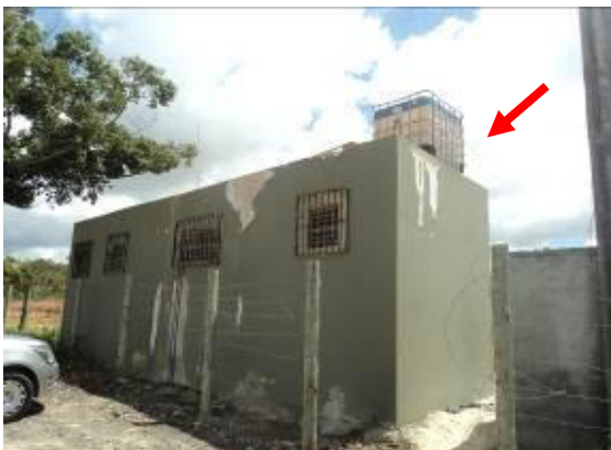
Figura 2.17 – Precariedade nas cercas de proteção na área do poço da Urca, com destaque para a facilidade de acesso aos produtos químicos utilizados na desinfecção (estavam sem identificação)
