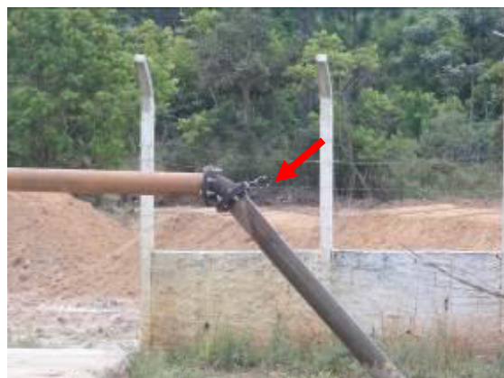
Figura 2.29 – Vazamento (em destaque) identificado no barrilete de recalque do poço Manteiga 2
