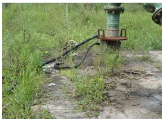
Figura 2.66 – Destaque para as instalações do poço CSB2
