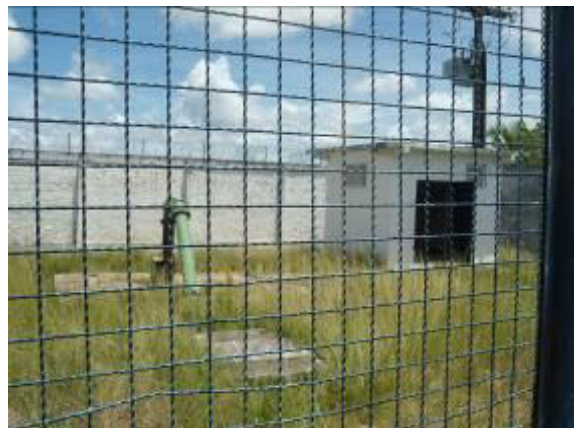
Figura 2.12 – Destaque para o poço CSB 4N
