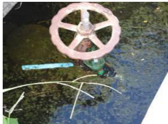
Figura 2.67 – Vazamento na caixa de registro do poço CSB2
