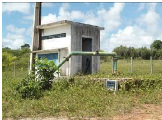
Figura 2.59 – Área onde está instalado o poço CSB4
