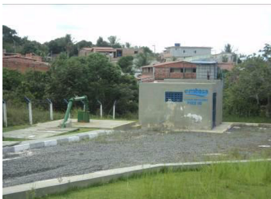
Figura 2.39 – Área onde está instalado o poço CSB6
