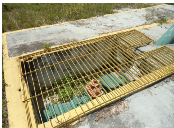
Figura 2.30 – Poço CSB1 – Caixa de registro protegida
