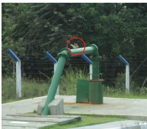
Figura 2.46 – Poço CSB6 – medidor de pressão (detalhe em vermelho)
