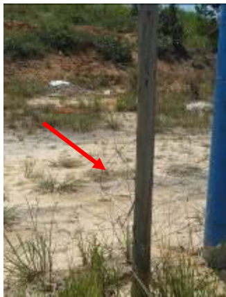
Figura 2.26 – Detalhe da cerca de proteção partida no poço da Urca (em destaque)
