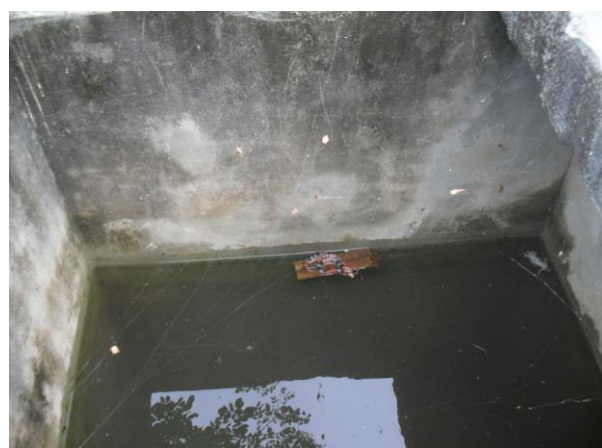
Figura 2.119 – Vazamento na caixa de registro
