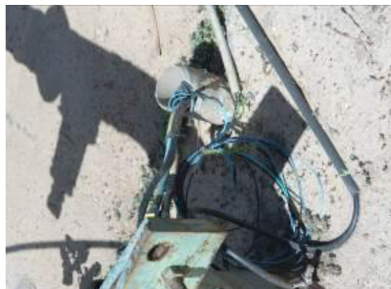
Figura 2.65 – Instalações elétricas aparentes no poço CSB1
