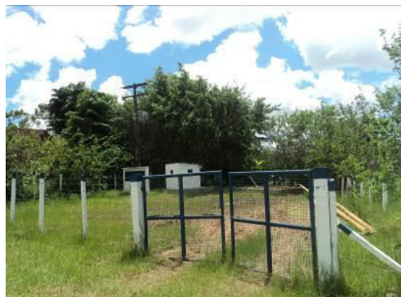
Figura 2.35 – Área onde está instalado o poço CSB3
