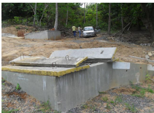
Figura 2.118 – Área da captação desorganizada
