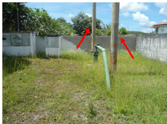
Figura 2.122 – Poço CSB3 (vista através portão de acesso), com destaque para as traves de içamento do CMB
