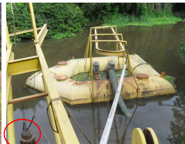
Figura 2.115 – Captação em plataforma flutuante e, detalhe vermelho, captação em bomba submersa
