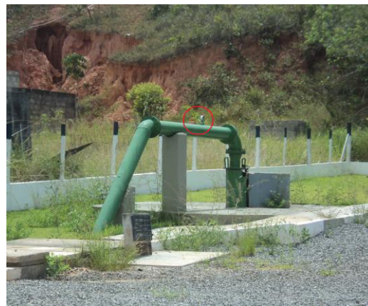
Figura 2.45 – Poço CSB5 – medidor de pressão (detalhe em vermelho)
