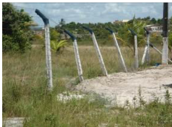
Figura 2.6 – Detalhe das cercas de proteção próximas à área do poço, encontram-se instaladas incorretamente
