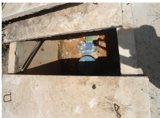
Figura 2.31 – Caixa de registro do poço CSB Urca, desprotegida e com presença de água acumulada
