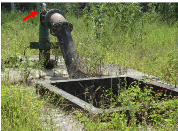
Figura 2.68 – Barriletes do poço CSB3 com destaque (em vermelho) para o medidor de pressão do mesmo
