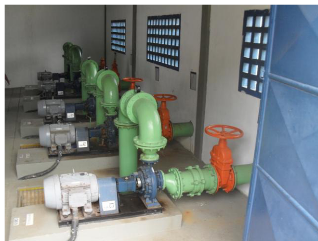
Figura 3.136 - Vista interna da EEAT1N, que abriga cinco conjuntos motobomba.
