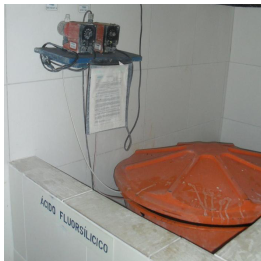
Figura 3.121 - Tanque de dosagem de ácido fluossilícico
