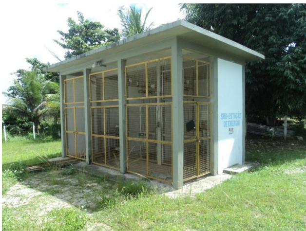
Figura 3.59 - Subestação abrigada, implantada ao fundo da área onde se localiza a EET1
