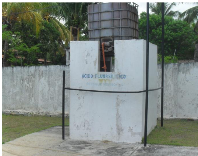
Figura 3.120 - Estrutura de apoio da bombona que armazena ácido fluossilícico concentrado, externo à Casa de Química
