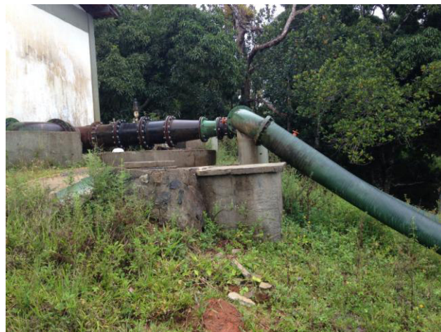
Figura 3.94 - Adutoras de água bruta
