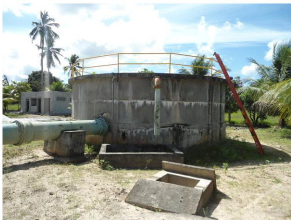
Figura 3.83 - Poço de sucção (130 m 3 ) da EEAT1A
