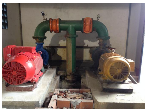
Figura 3.97 - Área interna da casa de bombas da EEAB2
