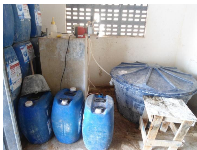
Figura 3.80 - Detalhe das instalações do sistema de fluoretação
