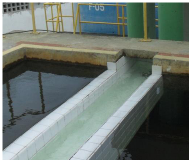
Figura 3.134 - Água efluente dos filtros (boa qualidade)
