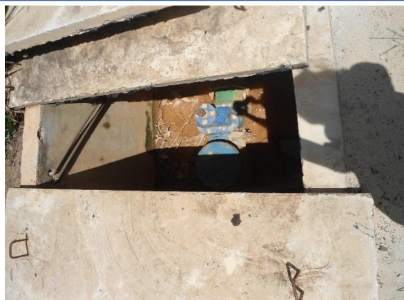
Figura 3.5 - Caixa de registro do poço CSB Urca, desprotegida e com presença de água acumulada
