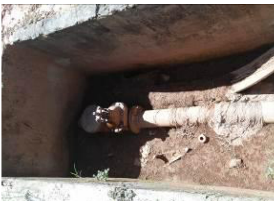
Figura 3.65 - Caixa de registro do poço CSB1, desprotegida
