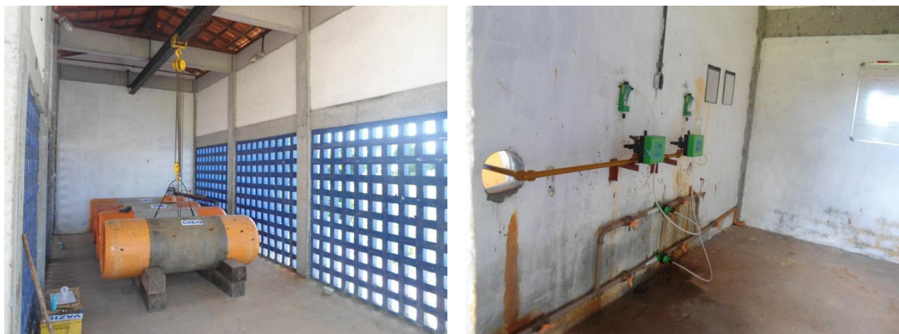
Figura 3.78 - Casa de cloração e cloradores – ETA Jordão
