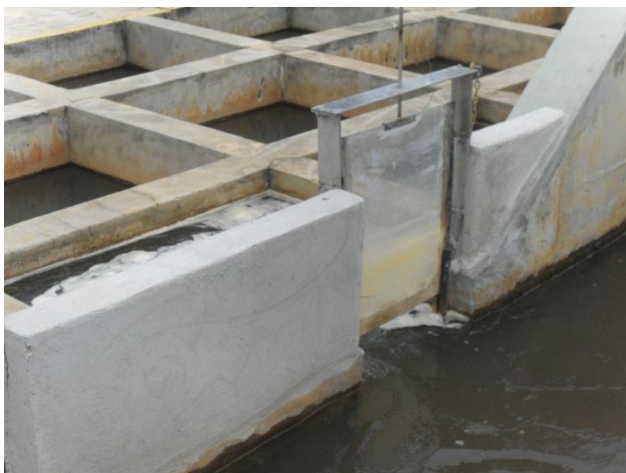
Figura 3.105 - Entrada da água bruta no floculador de chicanas verticais
