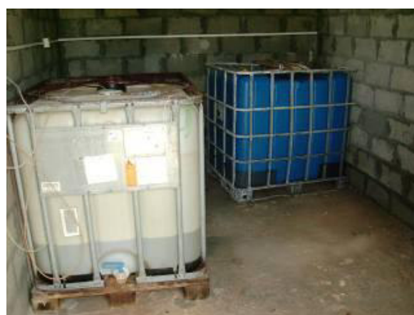
Figura 3.49 - Vista interna da unidade de tratamento do poço CSB6
