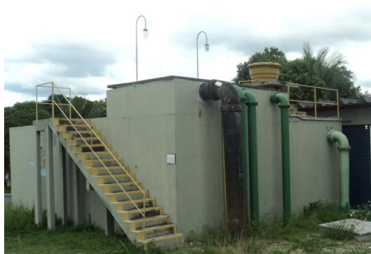
Figura 3.36 - Barriletes de chegada de água bruta no RAP de 160 m 3
