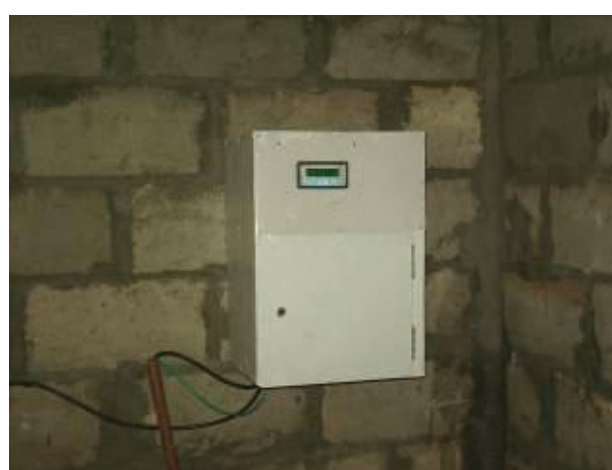
Figura 3.51 - Unidade Remota de leitura de vazão do poço CSB6
