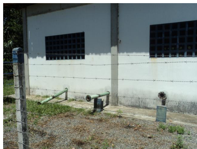
Figura 3.142 - Tubulações de sucção dos conjuntos secundários da EEAT2 (desativados)
