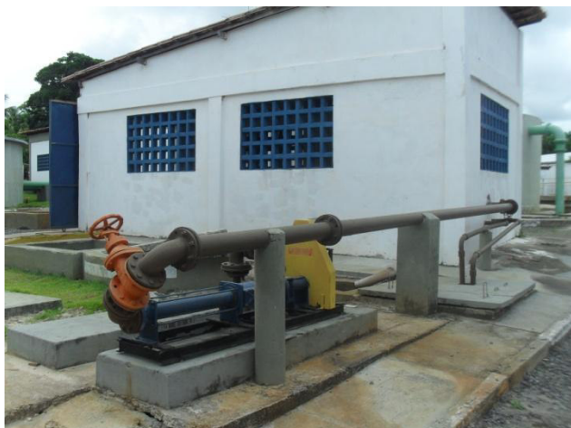
Figura 3.131 - Vista geral da área lateral à casa que abriga o filtro prensa, onde se observa a Elevatória de Efluentes 3 (EEE3), que succiona o lodo dos adensadores e encaminha para o filtro prensa
