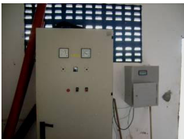
Figura 3.50 - Unidade Remota de Leitura de vazão do poço CSB5, instalada ao lado do quadro de comando
