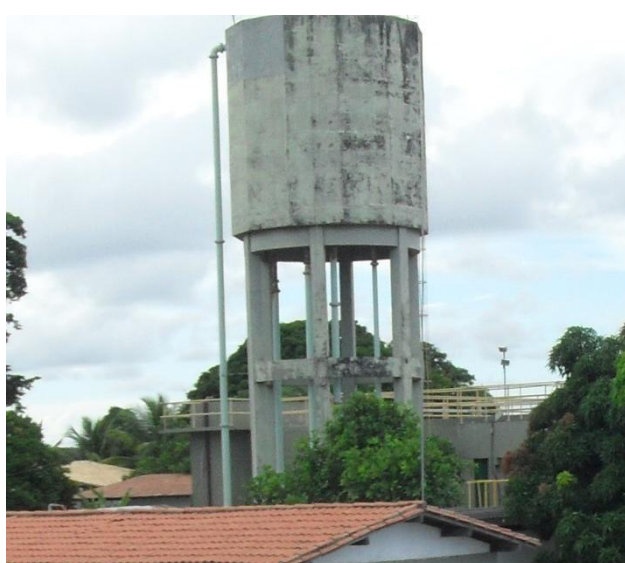
Figura 3.113 - REL de 150 m 3 (Lavagem dos Filtros)
