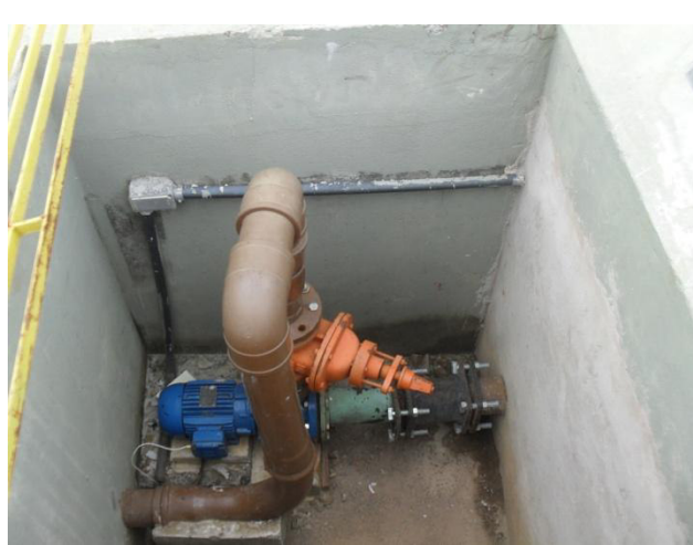
Figura 3.130 - Estação Elevatória de Efluentes 4 (EEE4)
