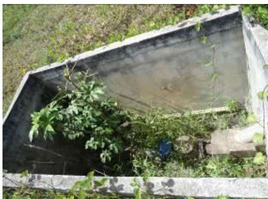
Figura 3.71 - Caixa de registro descoberta e com vegetação desenvolvida no poço CSB4
