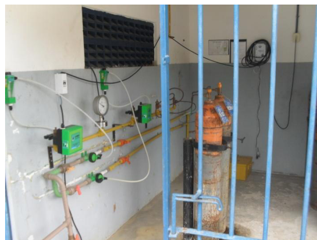
Figura 3.123 - Dosadores de cloro e cilindros de 50 kg
