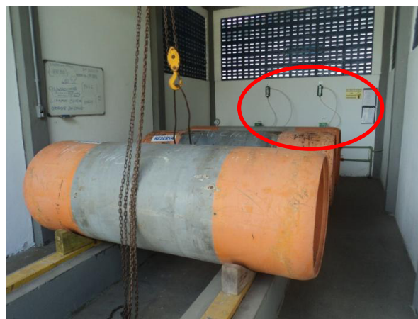
Figura 3.43 - Abrigo dos cilindros de cloro gás, com destaque para os cloradores instalados na parede do fundo
