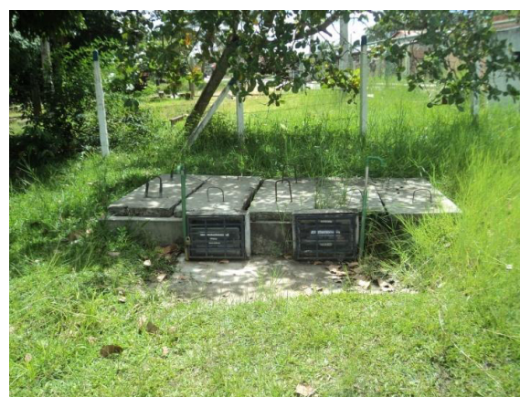
Figura 3.62 - Caixa de abrigo do medidor de vazão
