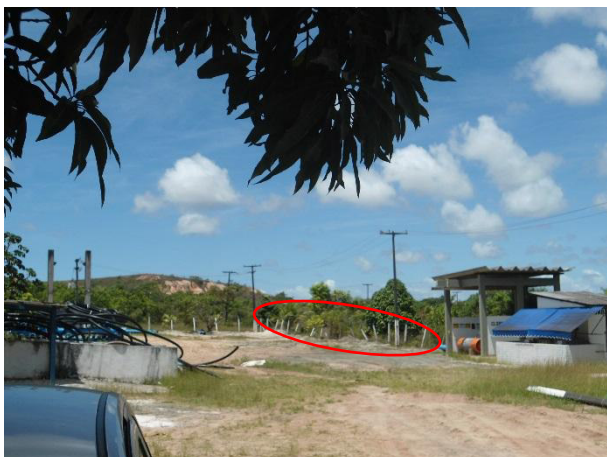
Figura 3.24 – Cercas de proteção em estado precário de instalação na ETA Espaço Alpha
