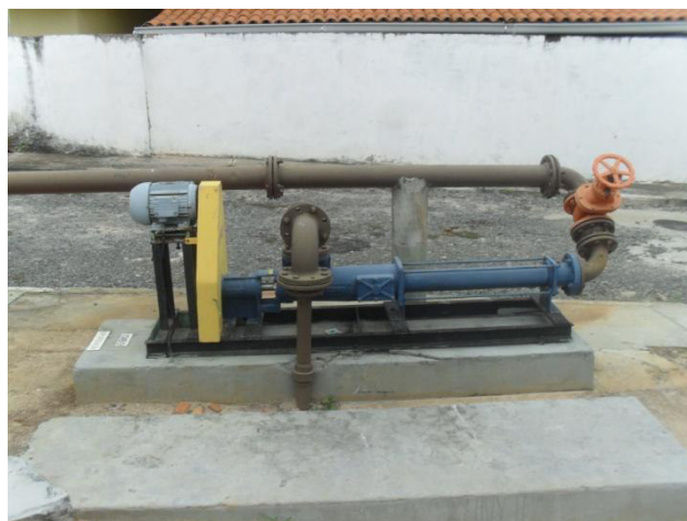
Figura 3.128 - Estação Elevatória de Efluentes 3 (EEE3)
