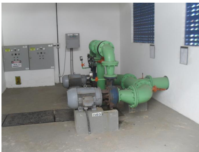
Figura 3.140 - Conjuntos motobomba da EEAT1
