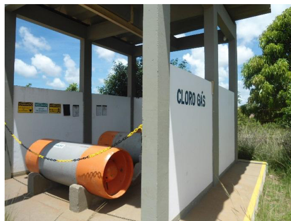
Figura 3.20 - Armazenamento e dosagem de cloro-gás
