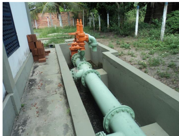
Figura 3.55 - Adutora de água tratada (recalque)
