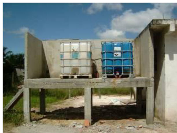
Figura 3.47 - Detalhe da estrutura de suporte das bombonas de hipoclorito de sódio (poço CSB5)
