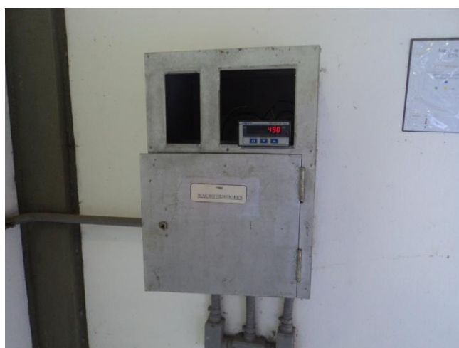
Figura 3.56 - Unidade de Leitura Remota, instalada no interior da EET1
