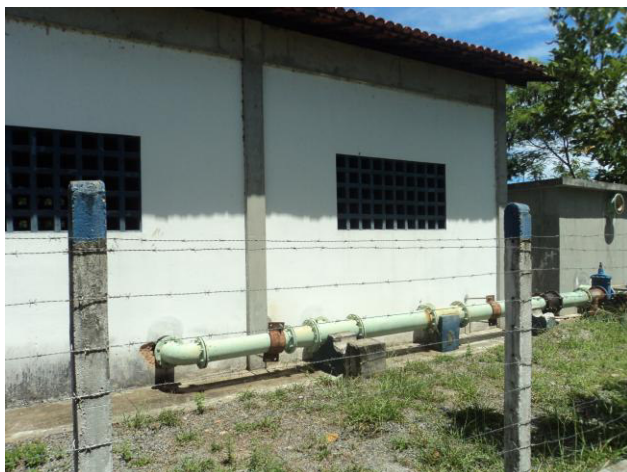
Figura 3.143 - Tubulações de sucção dos conjuntos principais da EEAT2
