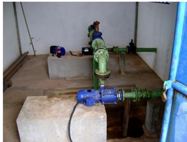
Figura 3.150 - Vista interna da EEAT4
