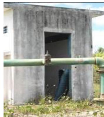
Figura 3.70 - Destaque para o abandono das instalações do poço CSB4
