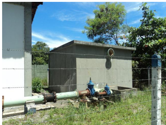
Figura 3.144 - Poço de sucção de 35 m 3 ("by passado")
