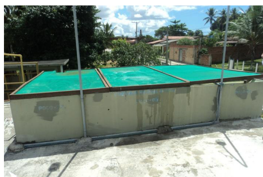
Figura 3.39 - Câmaras que recebem a água bruta dos poços CSB1, CSB3, CSB7, CSB9 e CSB10
