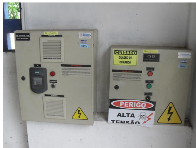
Figura 3.139 - Quadro de comando da EEAT1
