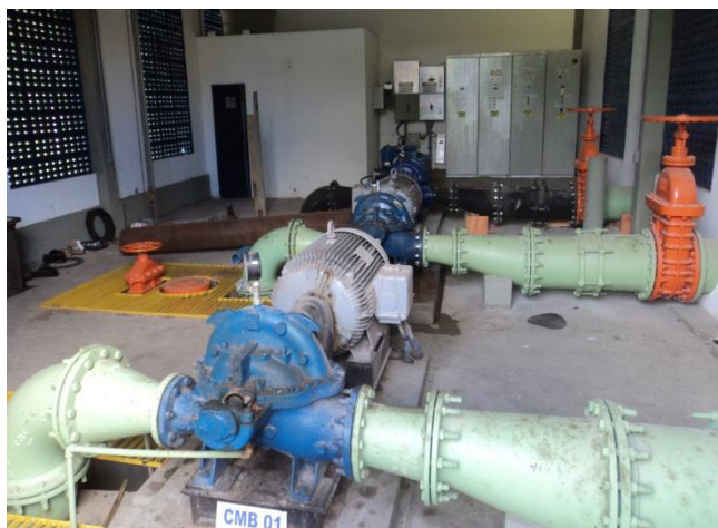
Figura 3.52 - Vista interna da EET1
