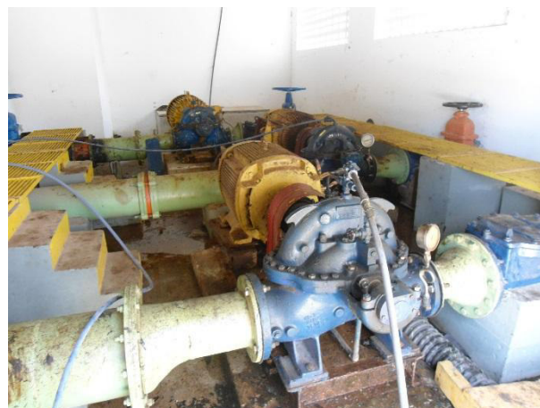
Figura 3.28 – Conjuntos motobomba da ETA Espaço Alpha
