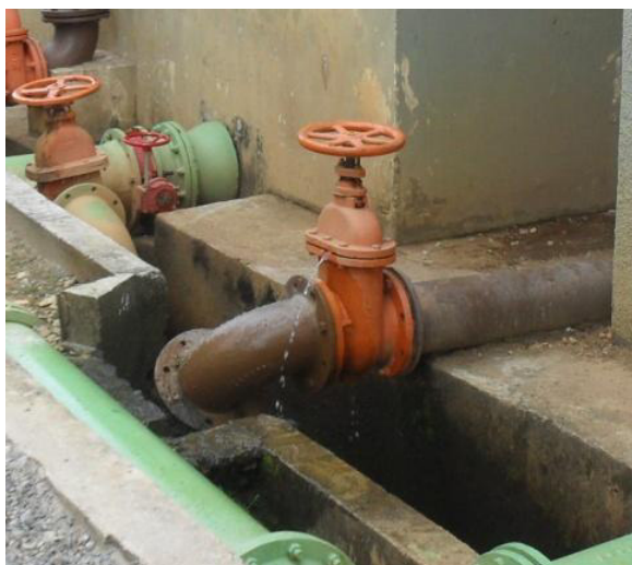
Figura 3.133 - Existência de vazamento
