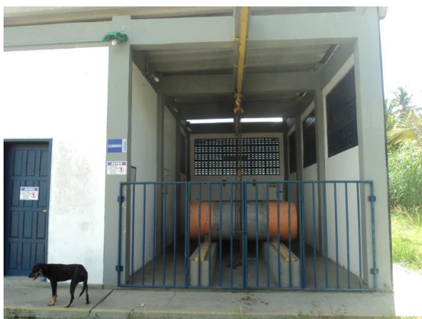
Figura 3.42 - Vista geral da Casa de Cloração
