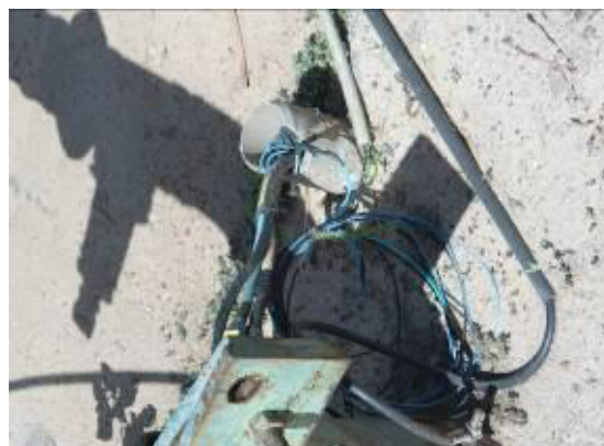
Figura 3.66 - Instalações elétricas aparentes no poço CSB1
