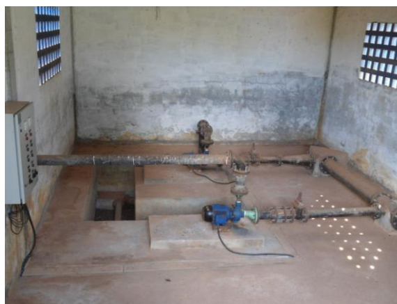
Figura 3.88 - Vista interna da EEAT2
