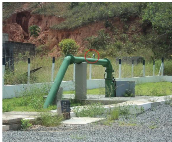
Figura 3.32 - Poço CSB5 – medidor de pressão (detalhe em vermelho)
