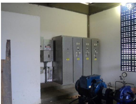
Figura 3.61 - Quadro de comando
