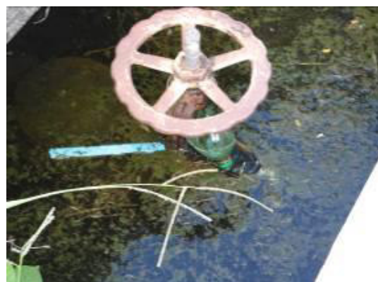
Figura 3.68 - Vazamento na caixa de registro do poço CSB2
