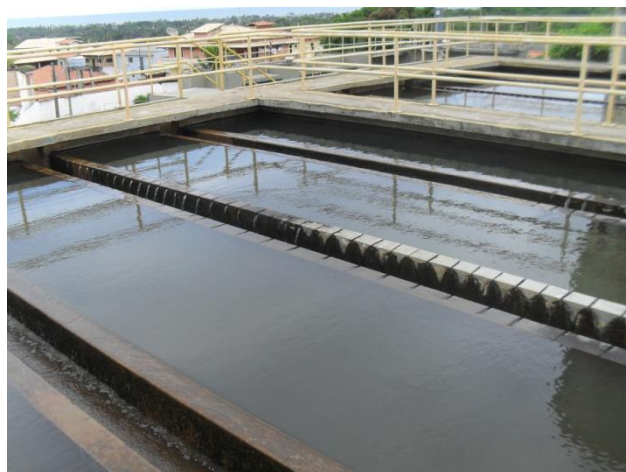
Figura 3.107 - Vista geral do decantador
