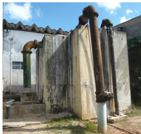
Figura 3.84 - Caixa de reunião de 55 m 3 , utilizado como poço de sucção da EEAT1
