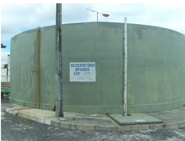
Figura 3.112 - RAP de 300 m 3 , utilizado como tanque de contato e poço de sucção da EEAT1
