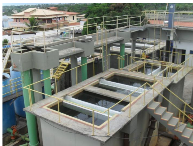
Figura 3.110 - Filtros russos de seção quadrada (em concreto)
