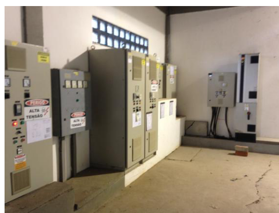
Figura 3.98 - Quadros de comando da EEAB2
