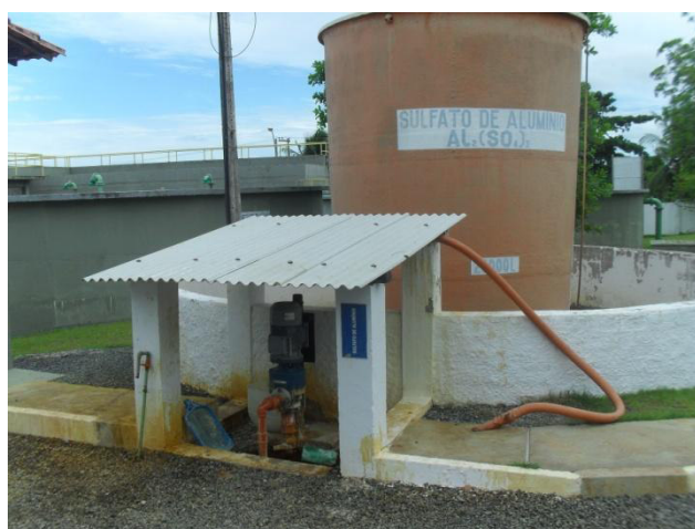
Figura 3.116 - Tanque de sulfato de alumínio e bomba dosadora na área externa.
