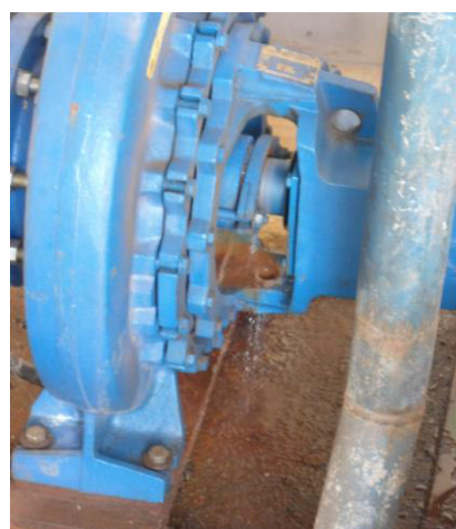
Figura 3.86 - Vazamento em um dos conjuntos motobomba da EEAT1
