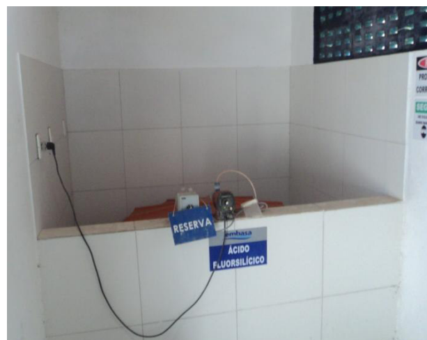
Figura 3.45 - Abrigo do tanque de diluição do ácido fluossilícico
