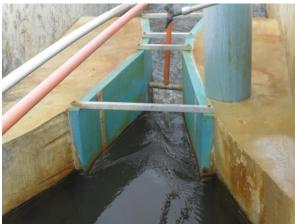
Figura 3.103 - Chegada da água bruta na unidade de mistura rápida (Calha Parshall)
