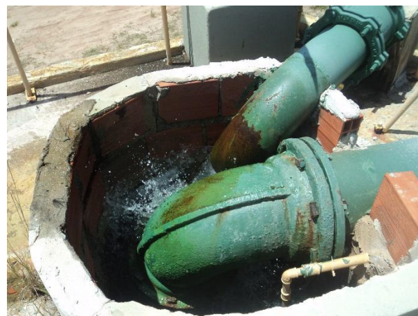
Figura 3.16 - Chegada da água bruta dos poços
