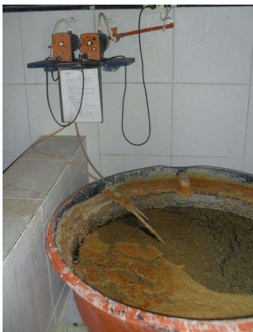
Figura 3.118 - Tanque de Sulfato de Alumínio instalado no interior da Casa de Química
