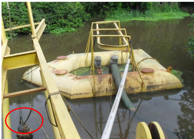
Figura 3.93 - Captação em plataforma flutuante (EEAB3) e, detalhe vermelho, captação em bomba submersa
