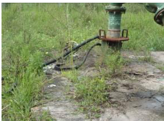
Figura 3.67 - Destaque para as instalações do poço CSB2
