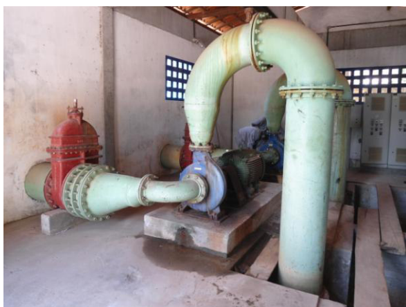
Figura 3.81 - Conjuntos motobomba da EEAT1A
