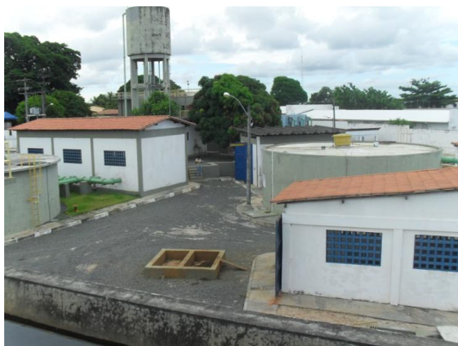
Figura 3.99 - Vista geral da ETA de Barra do Pojuca
