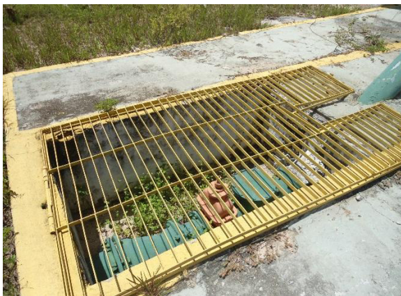
Figura 3.4 - Poço CSB1 – Caixa de registro protegida
