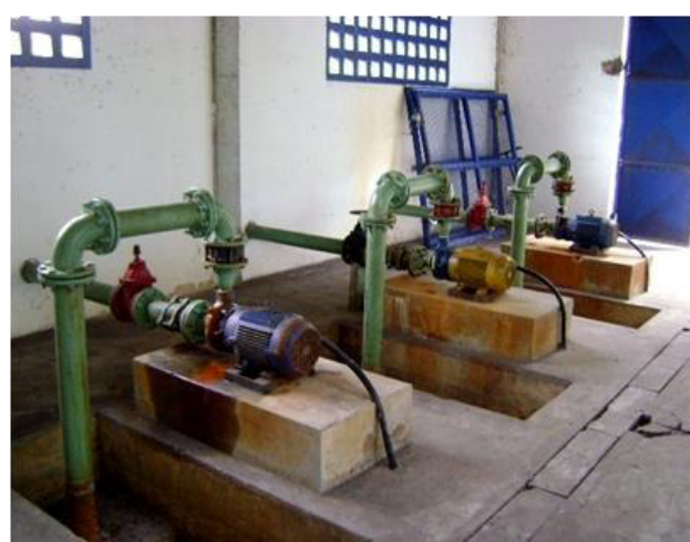
Figura 3.146 - Conjuntos secundários da EEAT2 (desativados) Fonte: EMBASA, 2013
