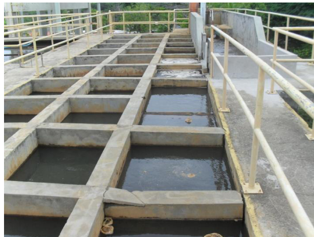
Figura 3.106 - Vista geral do floculador de chicanas verticais
