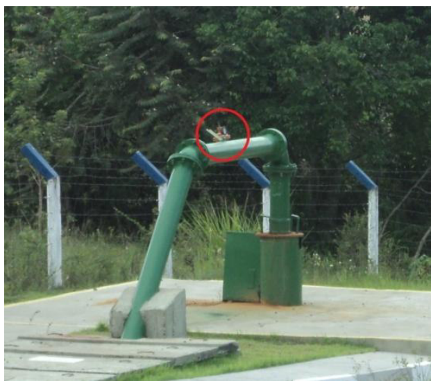
Figura 3.33 - Poço CSB6 – medidor de pressão (detalhe em vermelho)
