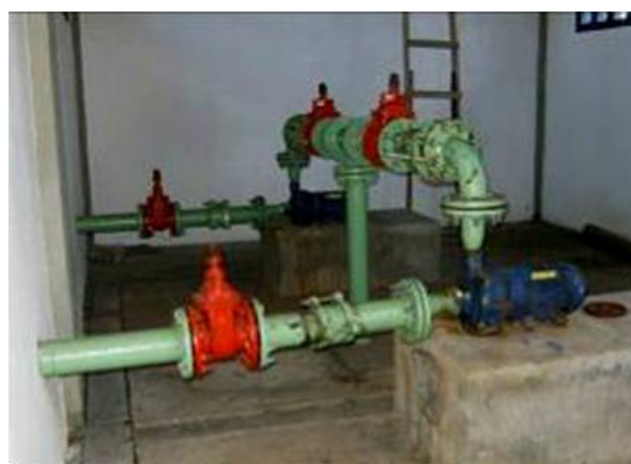
Figura 3.148 - Conjuntos motobomba da EEAT3
