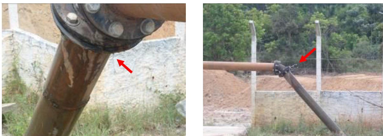
Figura 3.3 - Vazamento (em destaque) identificado no barrilete de recalque do poço Manteiga 2
