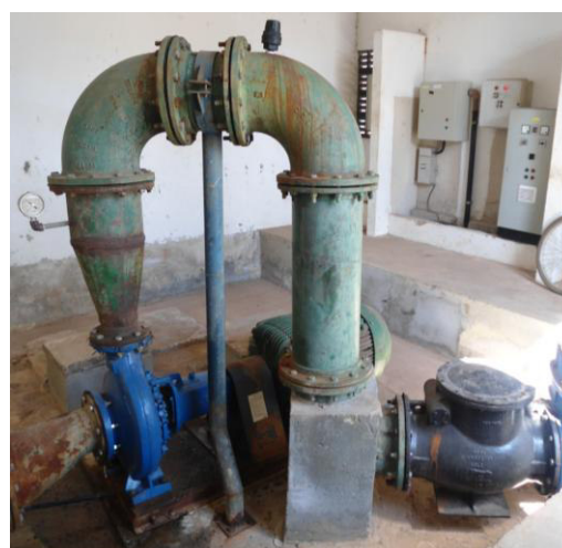
Figura 3.82 - Conjuntos motobomba da EEAT1
