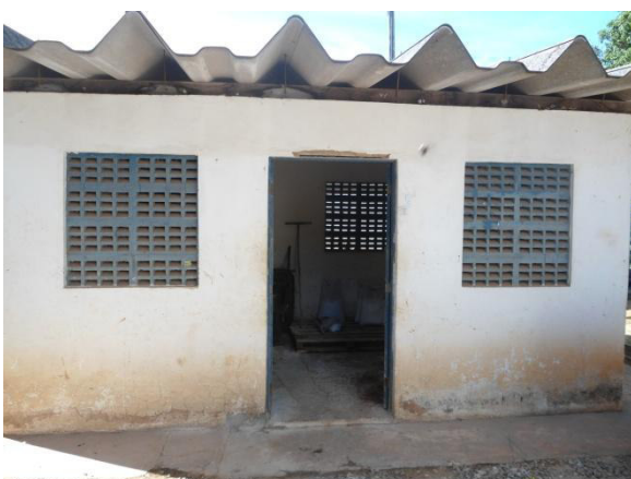
Figura 3.75 - Vista externa da área de depósito de produtos químicos
