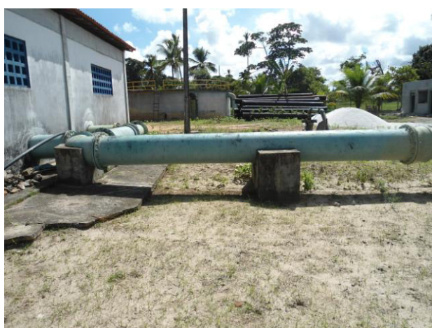
Figura 3.85 - Tubulação de sucção da EEAT1A
