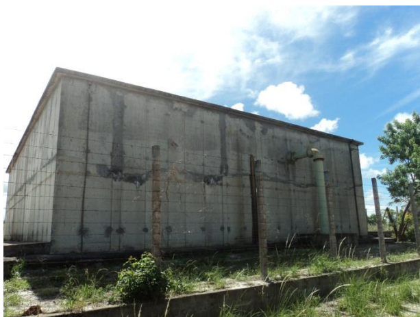
Figura 4.39 – Reservatório Apoiado de 1.000 m 3 (RAP 1.000)
