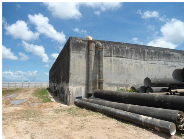
Figura 4.4 – Reservatório de distribuição de 6.000 m 3 (RAP 1)
