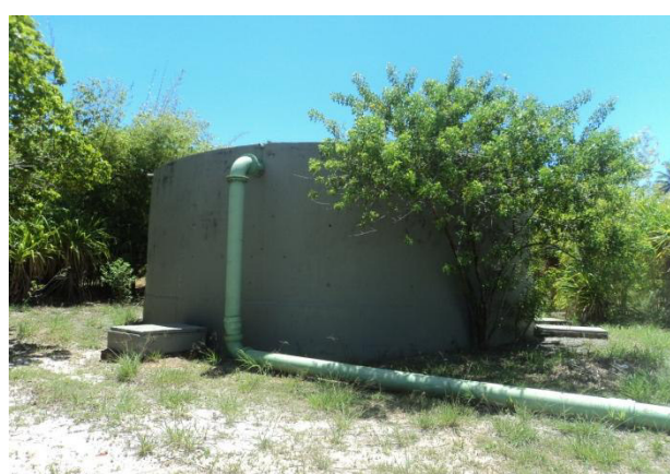
Figura 4.36 – Reservatório de 300 m 3 (RAP 300)
