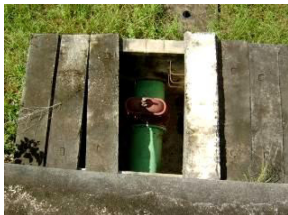
Figura 4.12 – Detalhe da caixa de abrigo dos barriletes de saída do RAP 900, onde se observa o registro de controle da adutora principal
