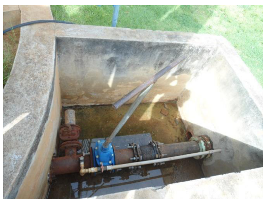
Figura 4.21 – Caixa de registro (RAP 1.500)
