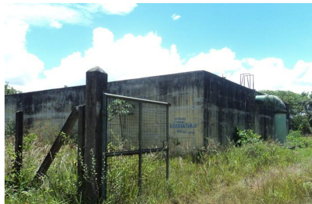
Figura 4.9 – Vista geral da área onde está instalado o RAP 900, com predominância de vegetação alta no entorno, o que é indicativo da falta de limpeza periódica.
