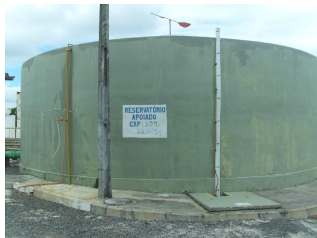
Figura 4.32 – RAP de 300 m³, utilizado como tanque de contato e poço de sucção da EEAT1
