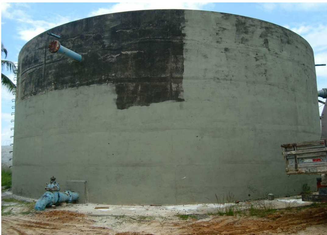
Figura 2.4 - Reservatório de Madre de Deus – RMD de 500 m 3
