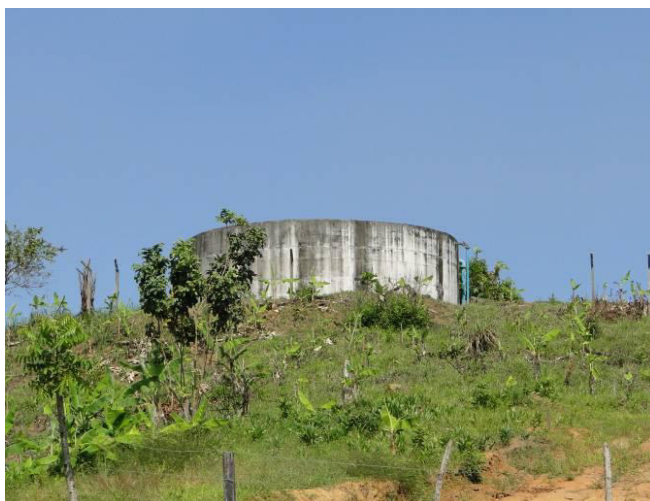
Figura 2.11 - Reservatório de 300 m³ em Gurugê
