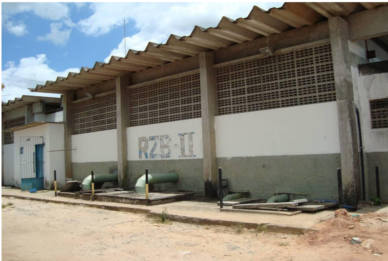
Figura 2.3 – Estação Elevatória na área do RZB-II de Candeias (EECA)
