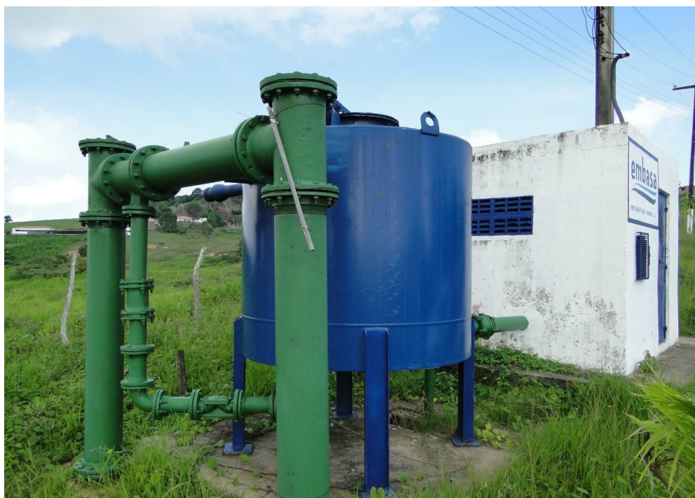
Figura 2.8 - Booster para Abastecer o Distrito de Monte Recôncavo
