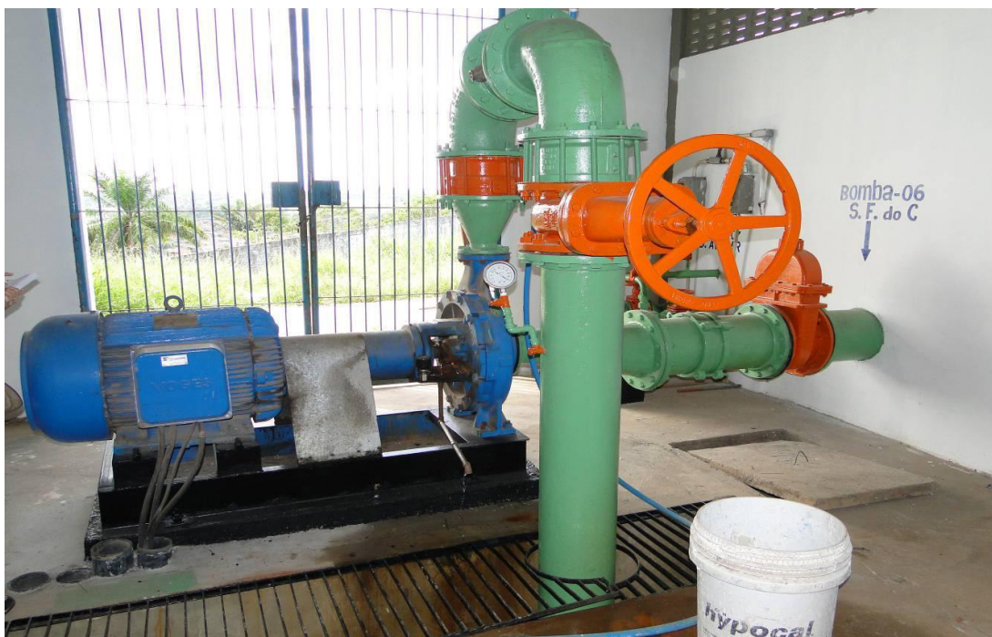
Figura 2.7 - Bombeamento para São Francisco do Conde na Estação Elevatória de Candeias (EECA)
