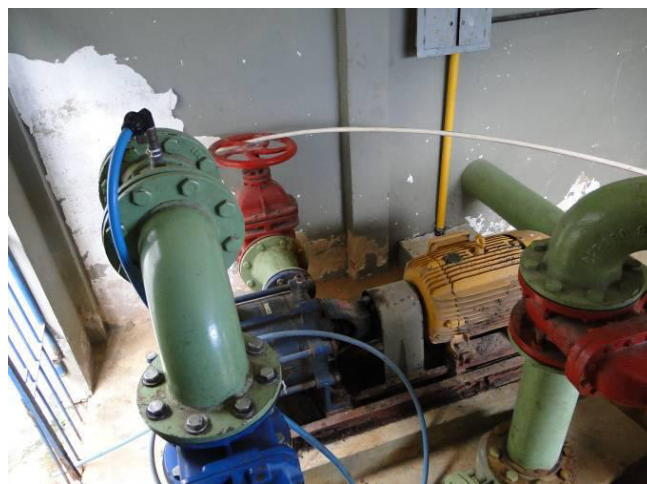
Figura 2.10 - Estação Elevatória de Água – Bombeamento para Gurugê e Campinas
