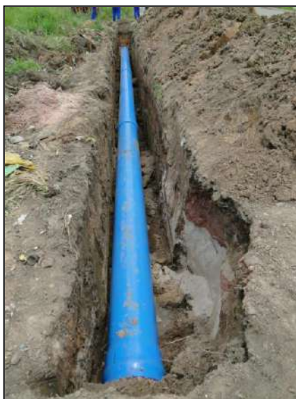
Figura 3. 4 – Reforço da Adutora Principal em PVC DEFºFº - Subsistema Madre de Deus
