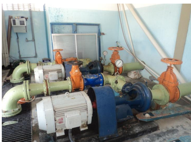
Figura 4.37 - EET– Vista dos conjuntos motobombas e barriletes de sucção e recalque. A placa do equipamento.
