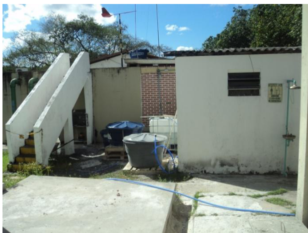
Figura 4.10 - Tanques provisórios utilizados na dosagem dos produtos químicos localizados à céu aberto. Bomba dosadora à esquerda, embaixo da escada. À direita, chuveiro e lava olhos de emergência.
