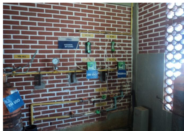
Figura 4.9 - Detalhe do interior da Casa de Cloração, onde se observa os Cilindros de Gás Cloro de 50 kg e os equipamentos de dosagem e injeção.
