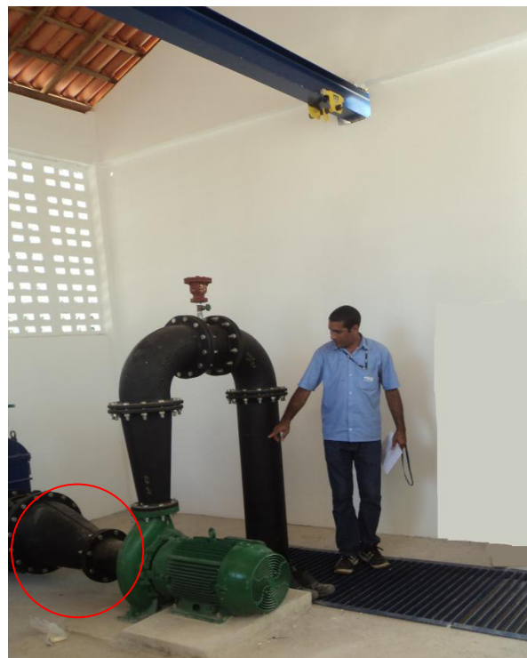
Figura 4.29 - EET2– Vista do conjunto motobomba e barriletes. Em destaque, a redução excêntrica na sucção montada com o cone para cima.
