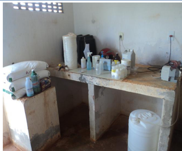
Figura 4.47- SAA Biribeira - Vista da Casa de química. Estoque de Barrilha e Bombas dosadoras de Cloro e Flúor.
