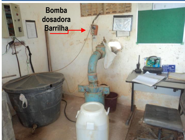
Figura 4.46 - SAA Biribeira – Vista do tanque de preparo e bomba dosadora de Barrilha. Necessidade de espaço adequado para o operador e melhorias nas instalações elétricas.
