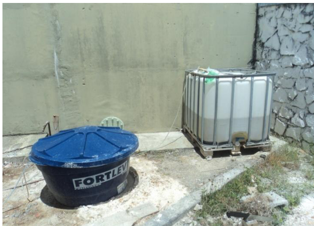
Figura 4.33 - Tanques utilizados na dosagem dos produtos químicos localizados à céu aberto.
