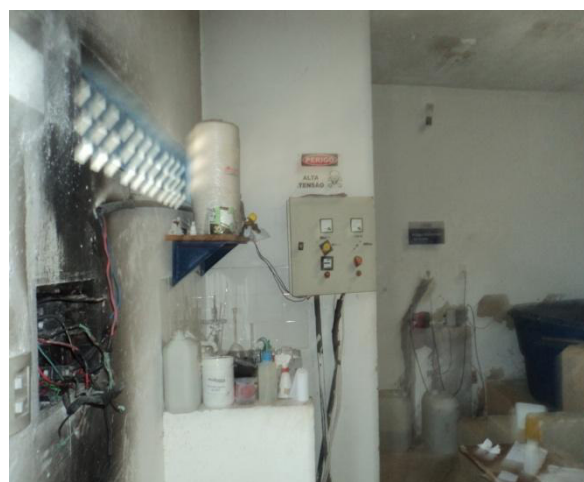
Figura 4.43 - SAA Leandrinho – Vista da Casa de química. Necessidade de espaço adequado para o operador e melhorias nas instalações elétricas.
