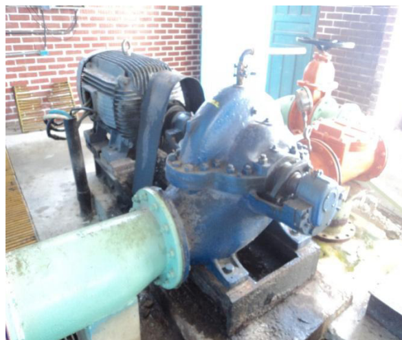
Figura 4.25- EET1 – Vista das instalações da Bomba 1- antiga (tipo bipartida)
