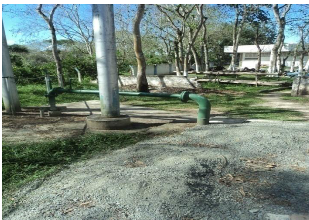
Figura 4.3 - Vista geral das instalações da EEB4 e EEB6.
