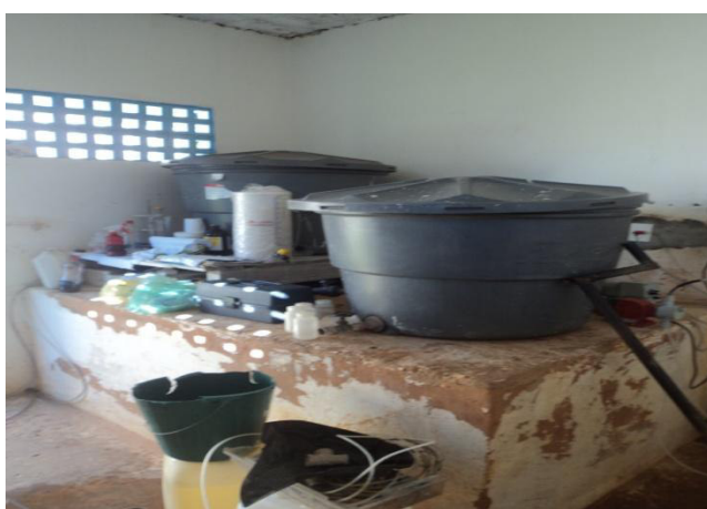
Figura 4.44 - SAA Futurama - Vista dos tanques de preparo, bombas dosadoras e estocagem dos produtos químicos.
