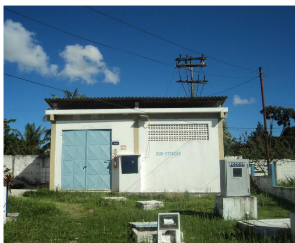
Figura 4.27- Vista da Subestação.
