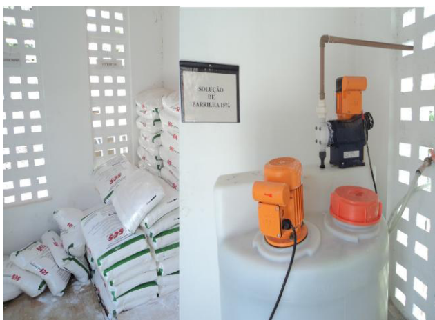
Figura 4.12- Casa de Química nova – Local de armazenagem e Equipamento de dosagem da Barrilha.
