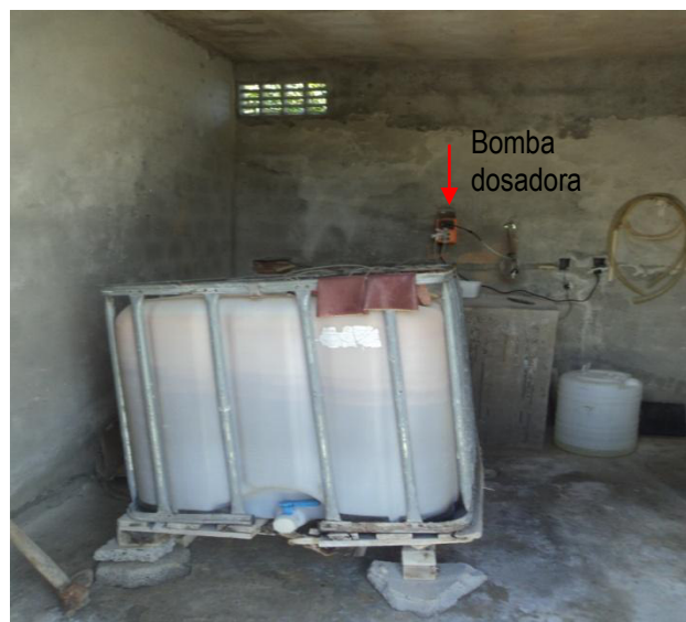
Figura 4.21 -Detalhe do interior da Casa de química, onde se observa o tanque de Hipoclorito de sódio e a bomba dosadora.
