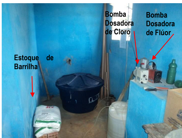
Figura 4.48 - SAA Boa Vista de Santa Helena - Vista dos tanques de preparo e bombas dosadoras de Barrilha e Cloro.
