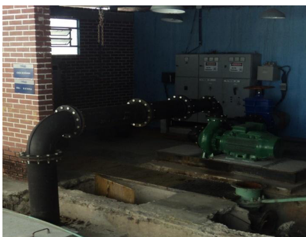
Figura 4.26- EET1 – Vista da bomba 2 (nova) e quadro de cargas.
