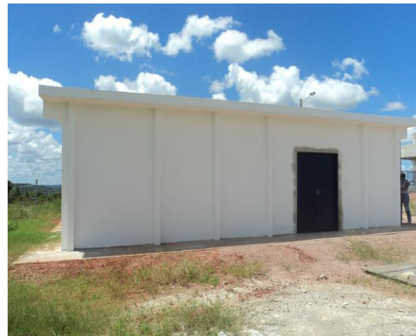
Figura 4.23 - Detalhe da lateral da nova Casa de química. Verifica-se falta de aberturas para ventilação. (Não foi possível acesso ao interior)
