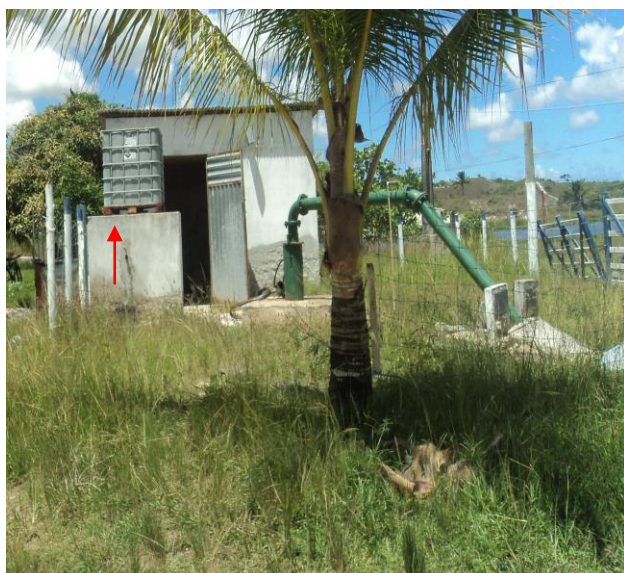
Figura 4.20 – Casa de Química da área do Poço CSB10 - Vista das instalações e tanque de Ácido Fluossilícico.
