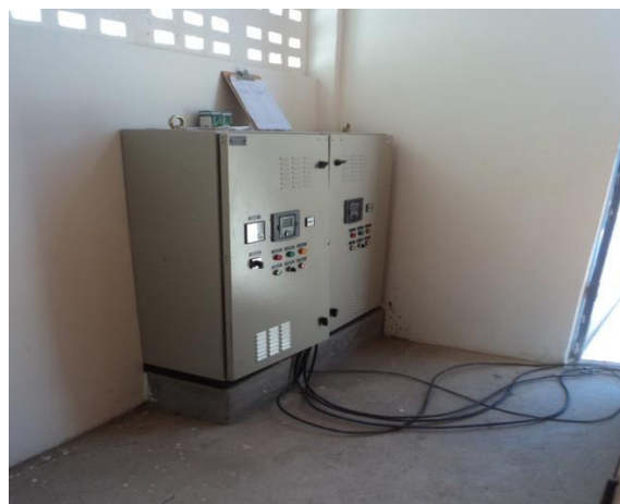
Figura 4.31 - EET2- Vista dos quadros de comandos.
