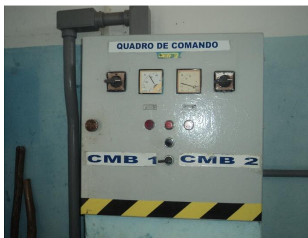
Figura 4.38 - Vista do quadro de comando.
