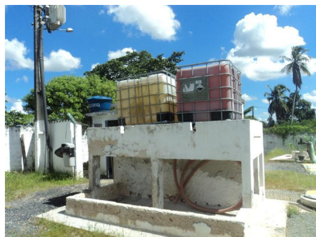
Figura 4.19 - Vista geral do armazenamento dos tanques de Ácido Fluossilícico.
