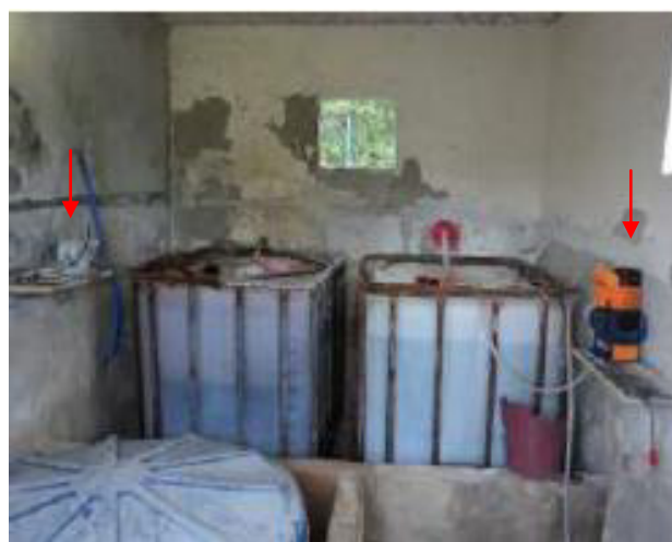
Figura 4.17 - Detalhe do interior da Casa de química, onde se observa os tanques e as bombas dosadoras.
