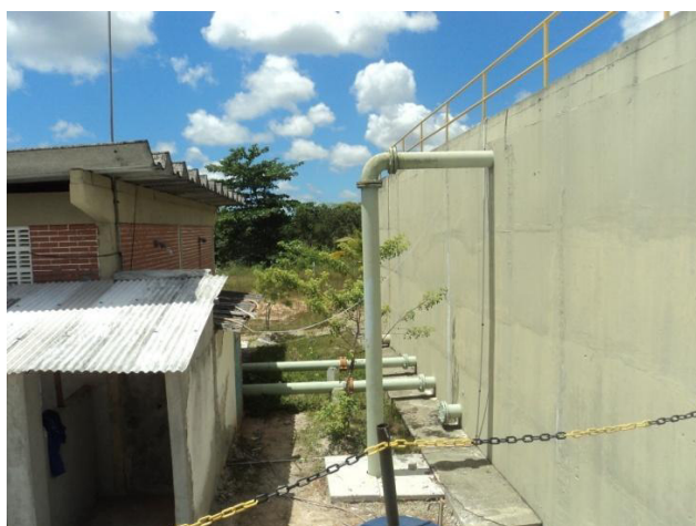
Figura 4.39 - Tanque de contato/Poço de Sucção 900m³ da EET.
