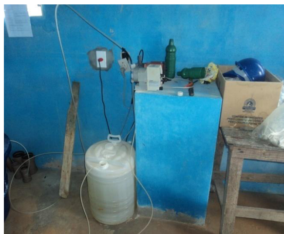
Figura 4.49- SAA Boa Vista de Santa Helena – Vista da Casa de química. Necessidade de espaço adequado para o operador e depósitos de produtos químicos
