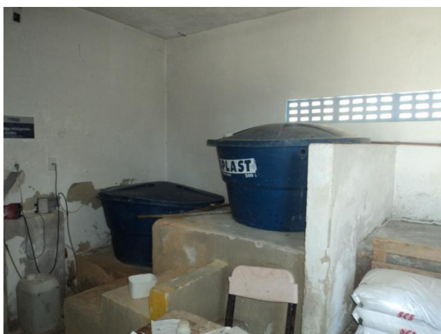
Figura 4.42 - SAA Leandrinho – Vista dos tanques de preparo, bombas dosadoras e estocagem dos produtos químicos.
