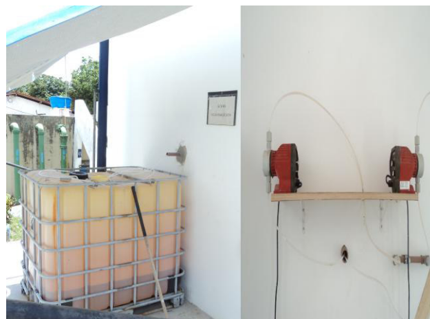
Figura 4.13- Casa de Química nova – Local de armazenagem e Equipamento de dosagem do Ácido Fluossilícico.
