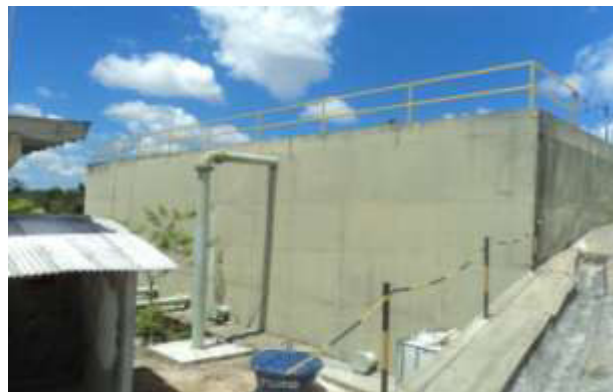
Figura 5.16 - RAP – Reservatório Apoiado 900m³ – Vista dos tubos de extravasão e sucção da EEAT.
