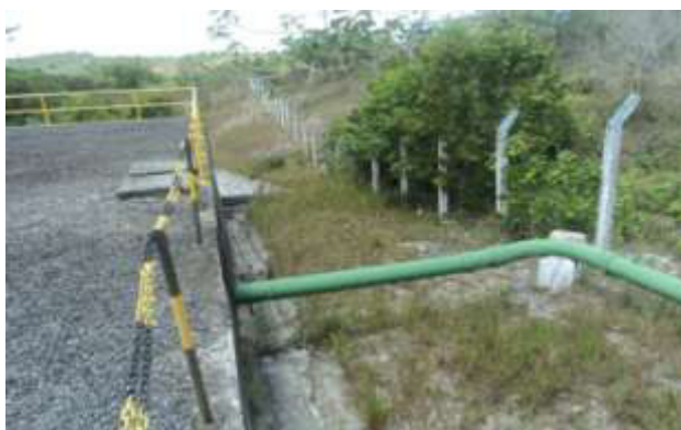
Figura 5.15 - RAP – Reservatório Apoiado 900m³ – Tubo de chegada do Poço
