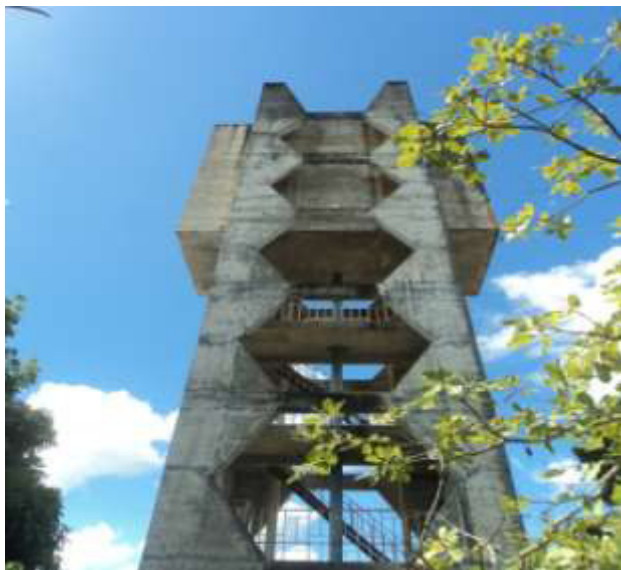
Figura 5.3 - Reservatório Elevado de Distribuição - RED 400m³ –(Fora de Operação).
