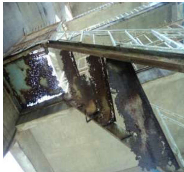
Figura 5.4 - Escada de acesso ao RED 400m³ com elevado grau de deterioração.
