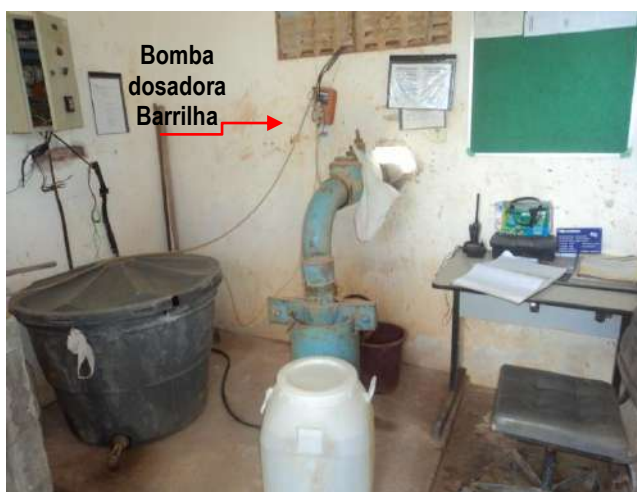
Figura 3.15 - SAA Biribeira – Vista do tanque de preparo e bomba dosadora de Barrilha.
