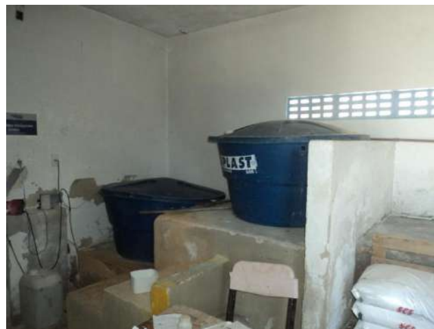
Figura 3.14 - SAA Leandrino – Vista dos tanques de preparo, bombas dosadoras e estocagem dos produtos químicos.
