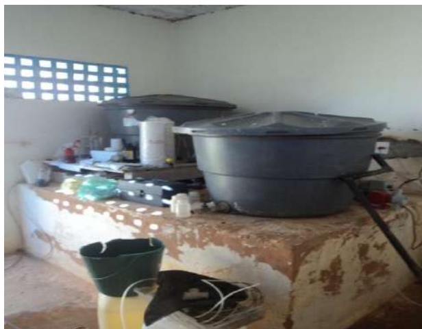
Figura 3.13 - SAA Futurama – Vista dos tanques de preparo, bombas dosadoras e estocagem dos produtos químicos.
