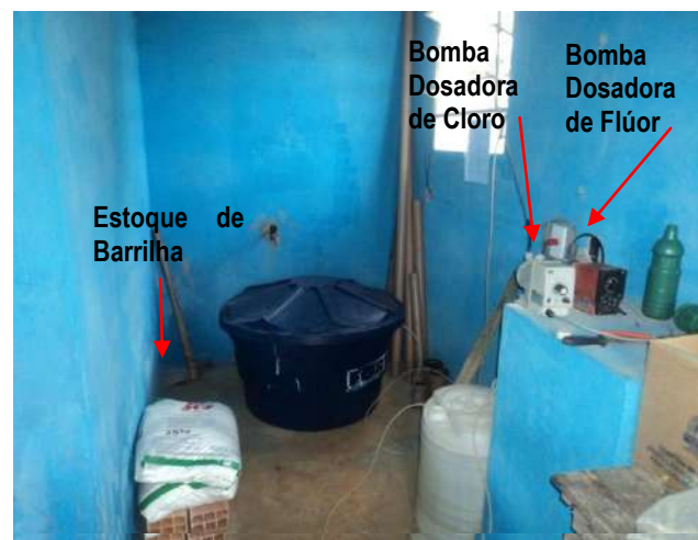
Figura 3.16- SAA Boa Vista de Santa Helena - Vista dos tanques de preparo e bombas dosadoras de Barrilha e Cloro.
