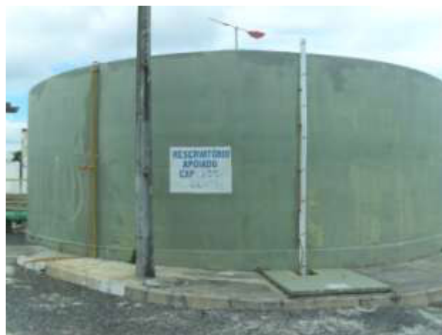
Figura 6.28 - RAP de 300 m³, utilizado como tanque de contato e poço de sucção da EEAT1
