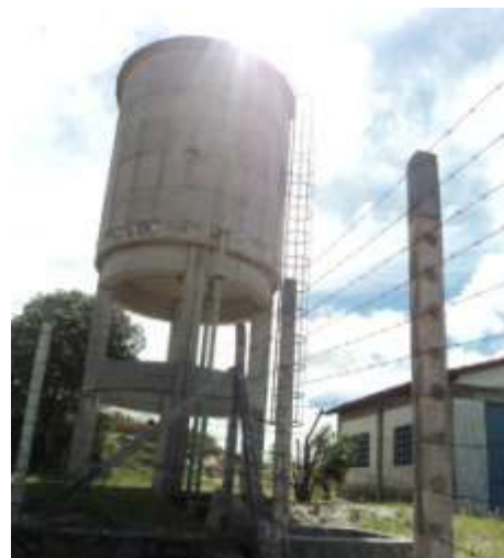
Figura 6.38 - Reservatório Elevado de 70 m 3 (REL 70)
