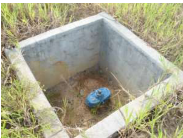
Figura 6.5 -Caixa de registro desprotegida
