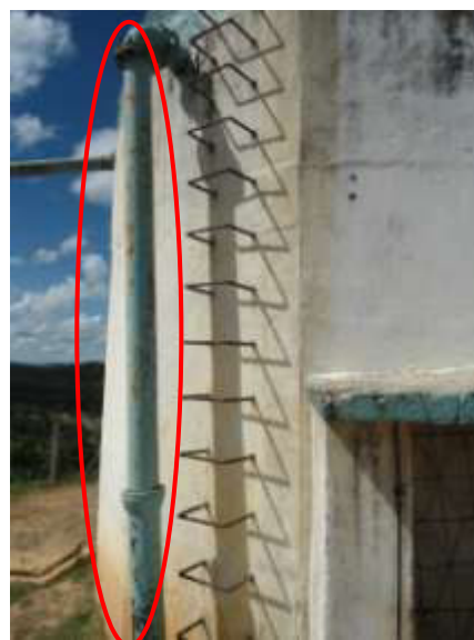
Figura 6.20 - Escada do reservatório oxidada, detalhe em vermelho tubulação de chegada da água tratada (RAP 100)
