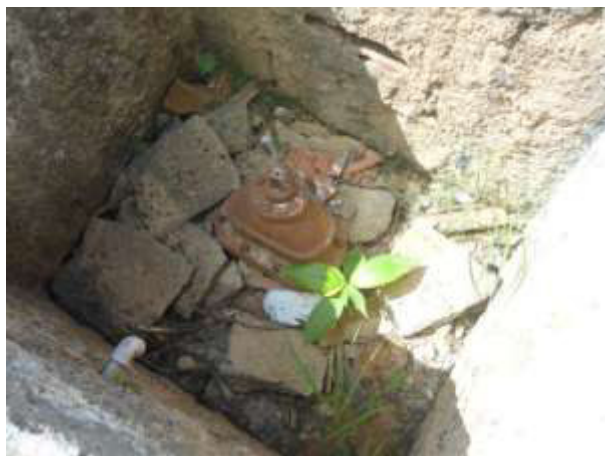
Figura 6.19 - Caixa de registro desprotegida (RAP 100)
