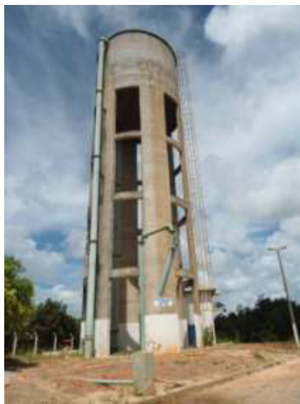
Figura 6.51 - Reservatório elevado com capacidade de 200 m 3 (REL 200)
