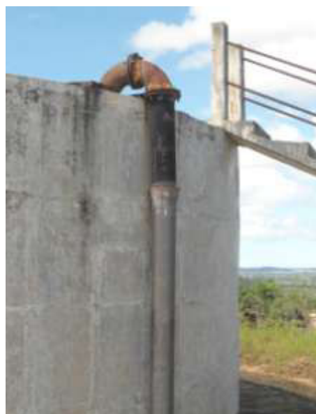
Figura 6.6 -Tubulação de chegada de água tratada (parte da tubulação encontra-se oxidada)
