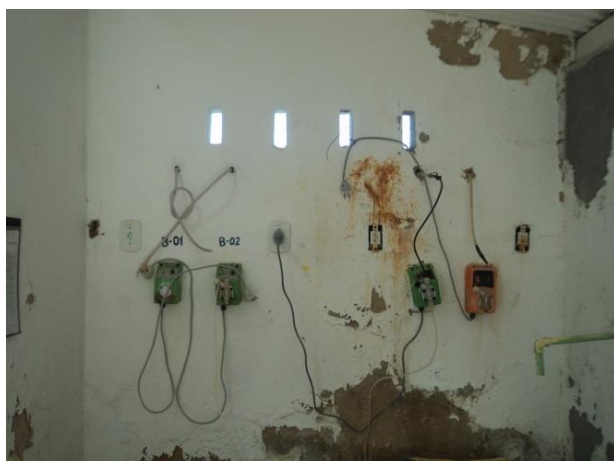
Figura 5.133 – Interior da casa de química, detalhe bombas dosadoras
