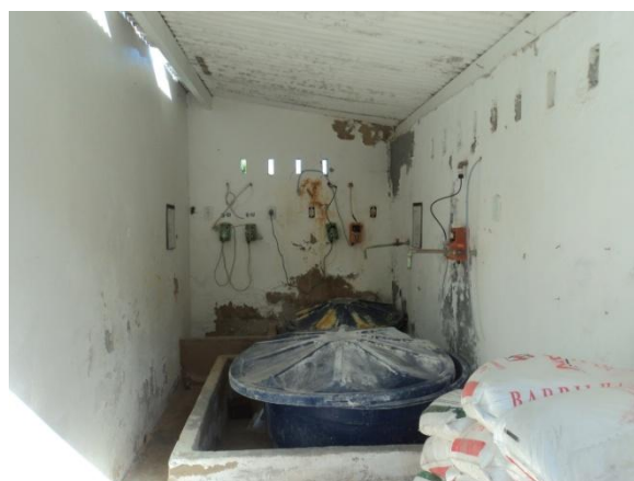
Figura 5.131 – Interior da casa de química, sala onde são preparadas as soluções e armazenados os produtos químicos utilizados no processo de tratamento da água
