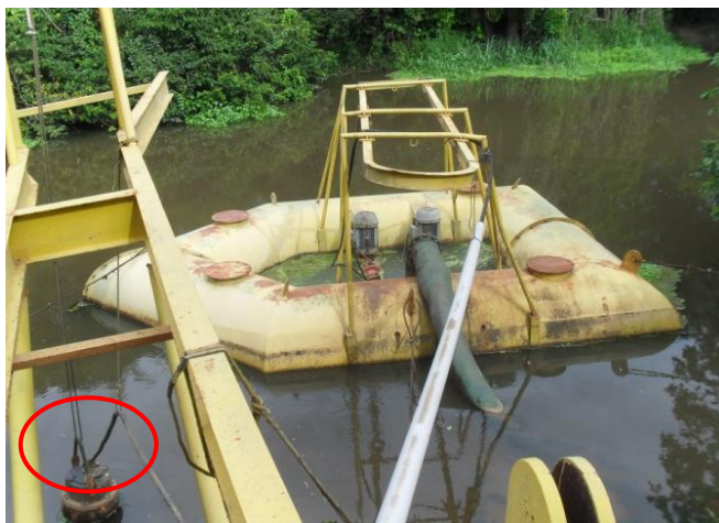
Figura 5.15 - Captação em plataforma flutuante EEAB3) e, detalhe vermelho, captação em bomba submersa
