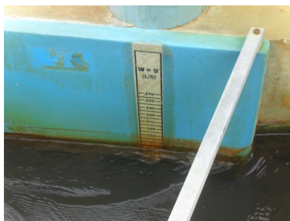
Figura 5.26 - Medição da vazão afluente à ETA
