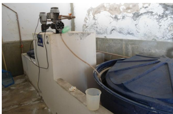
Figura 5.97 – Reservatórios utilizados para dosagem e aplicação suspensão de barrilha nos RAPs de 2.000 m 3
