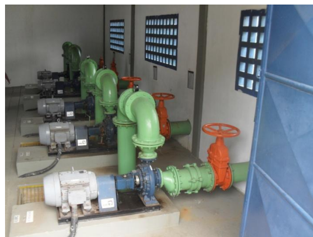
Figura 5.58 - Vista interna da EEAT1N, que abriga cinco conjuntos motobomba.
