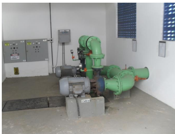
Figura 5.62 - Conjuntos motobomba da EEAT1
