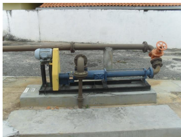
Figura 5.50 - Estação Elevatória de Efluentes 3 (EEE3)
