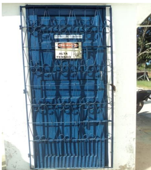
Figura 5.142 – Sala do quadro de comando
