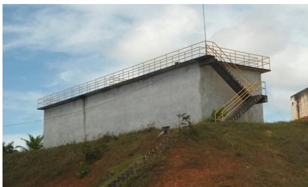
Figura 5.114 – Reservatórios de armazenamento do lodo, onde seria realizado o adensamento do lodo transferido dos reservatórios de coleta
