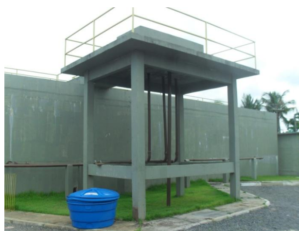
Figura 5.48- Vista da Caixa Repartidora de Vazão (CRV)
