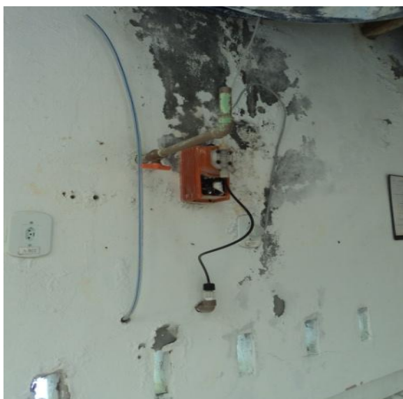
Figura 5.135 – Bomba dosadora da solução de carbonato de sódio, barrilha
