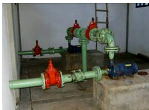
Figura 5.70 - Conjuntos motobomba da EEAT3
