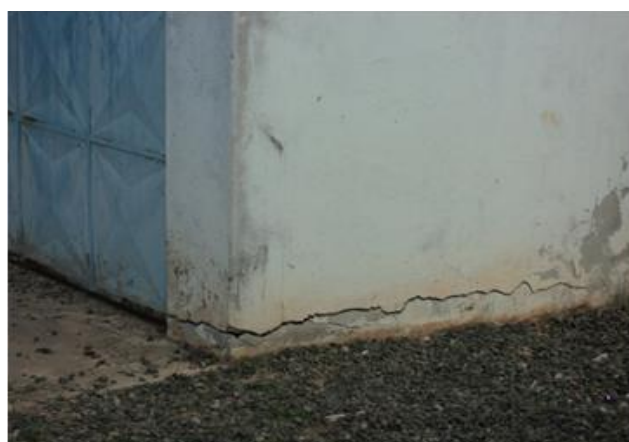
Figura 5.10 – Unidade de Tratamento do poço CSB9N, problemas estruturais rachaduras na edificação
