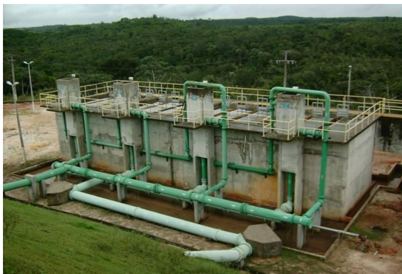
Figura 5.84 – Vista geral dos Filtros Russos e dos barriletes de admissão de água bruta e de água de lavagem Fonte: EMBASA, 2013.
