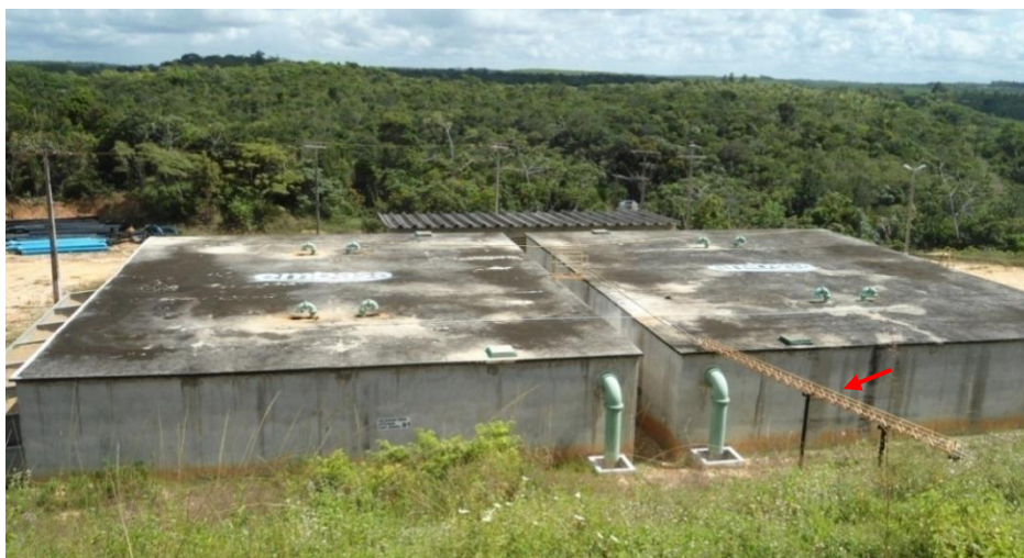
Figura 5.108 – Aplicação dos produtos químicos cloro gás, ácido fluossilícico e barrilha, tubulações indicadas em vermelho
