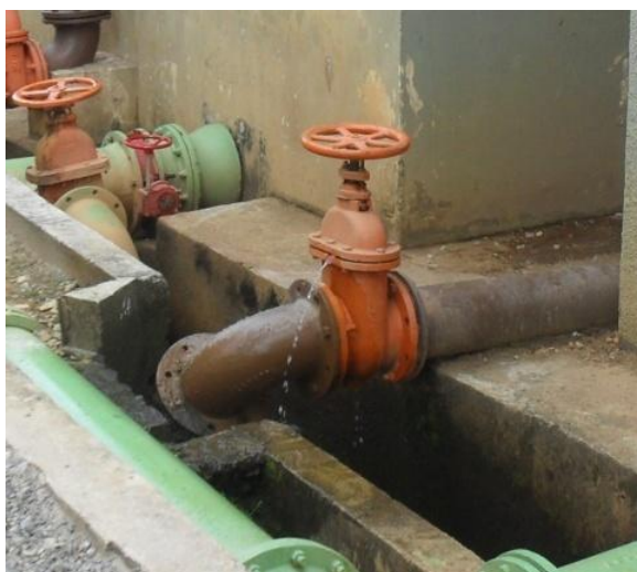
Figura 5.55 - Existência de vazamento
