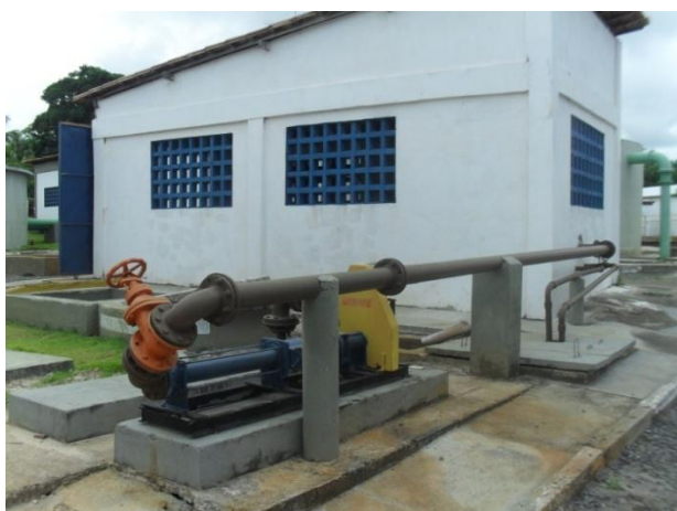
Figura 5.53 - Vista geral da área lateral à casa que abriga o filtro prensa, onde se observa a Elevatória de Efluentes 3 (EEE3), que succiona o lodo dos adensadores e encaminha para o filtro prensa
