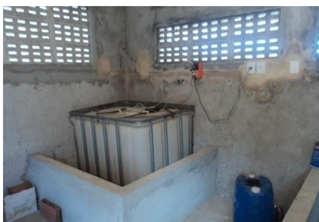
Figura 5.9 – Detalhe da Bomba Dosadora de Ácido Fluossilícico unidade de tratamento do poço CSB8N
