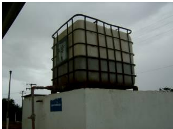
Figura 5.99 – Bombona de ácido fluossilícico concentrado, situada fora da Casa de Química
