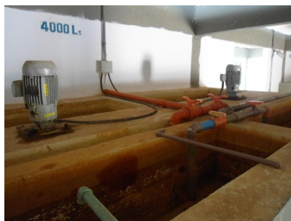
Figura 5.92 – Detalhe da parte superior dos tanques de preparo da solução de sulfato de alumínio
