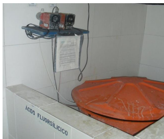
Figura 5.43 - Tanque de dosagem de ácido fluossilícico
