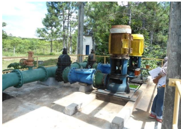
Figura 5.76 – Conjuntos motobomba responsáveis pela captação
