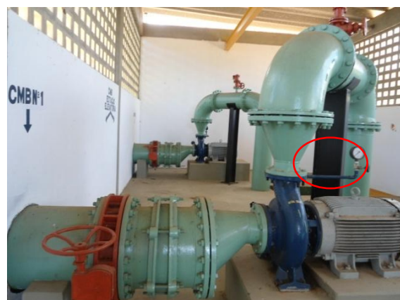
Figura 5.123 – Segundo sistema de recalque responsável pela alimentação do REL de 200 m³, com destaque para o medidor de pressão na tubulação de recalque
