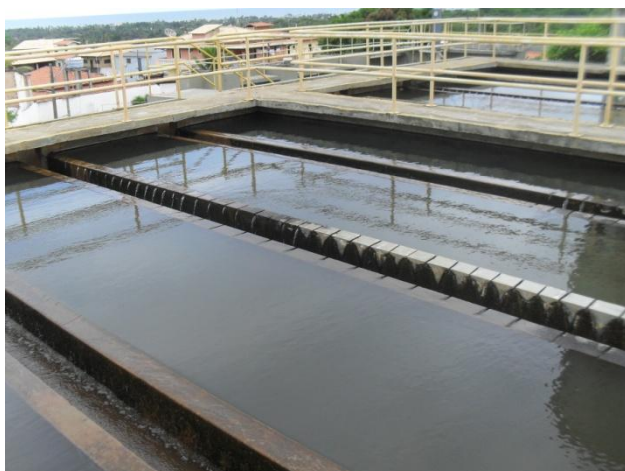
Figura 5.29 - Vista geral do decantador
