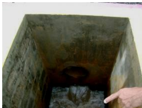
Figura 5.81 – Câmara de chegada da água bruta
