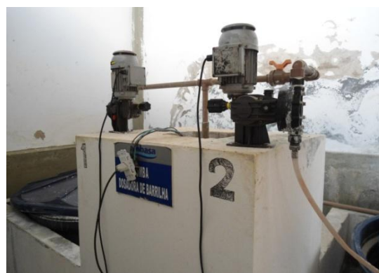
Figura 5.98 – Conjuntos de bombas dosadoras de barrilha
