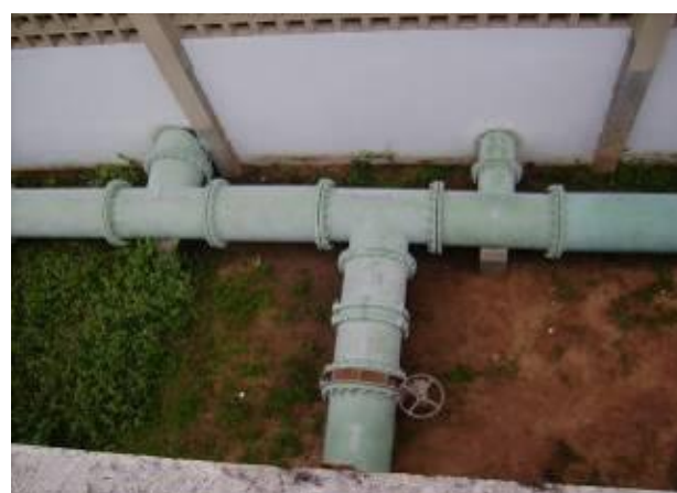
Figura 5.125 – Detalhe da entrada dos barriletes de sucção na casa de bombas da EET1
