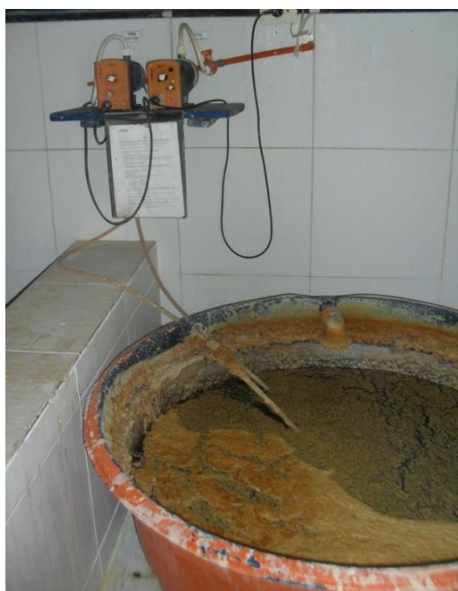
Figura 5.40 - Tanque de Sulfato de Alumínio instalado no interior da Casa de Química
