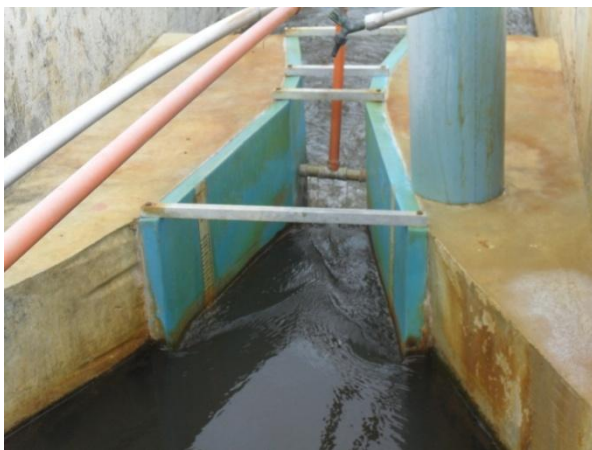
Figura 5.25 - Chegada da água bruta na unidade de mistura rápida (Calha Parshall)
