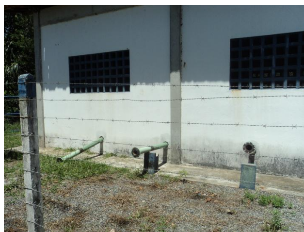
Figura 5.64 - Tubulações de sucção dos conjuntos secundários da EEAT2 (desativados)
