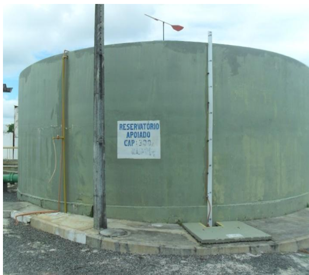
Figura 5.34 - RAP de 300 m³, utilizado como tanque de contato e poço de sucção da EEAT1
