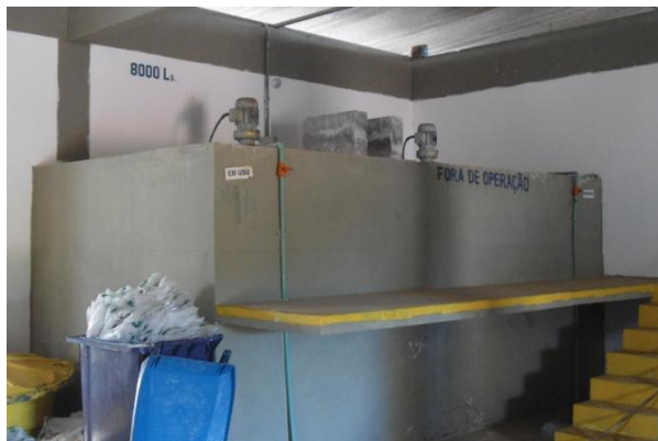
Figura 5.95 – Tanques de preparo da solução de barrilha
