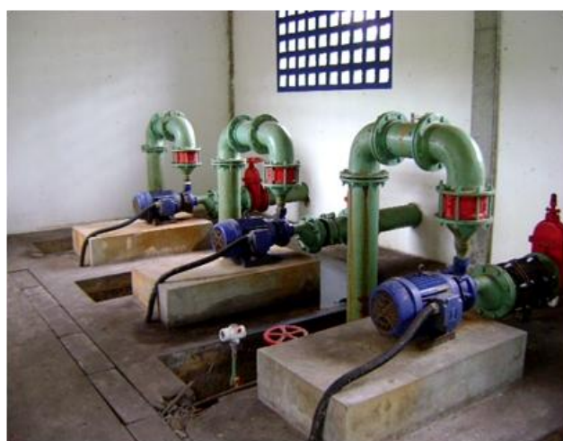
Figura 5.67 - Conjuntos principais da EEAT2
