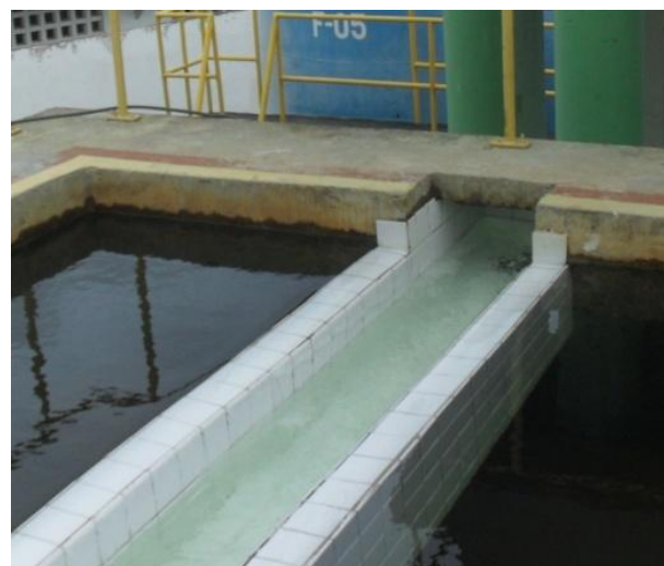
Figura 5.56 - Água efluente dos filtros (boa qualidade)
