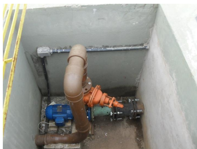
Figura 5.52- Estação Elevatória de Efluentes 4 (EEE4)
