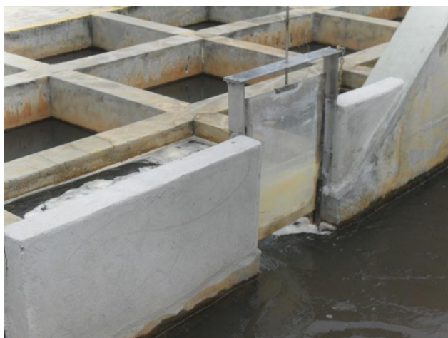
Figura 5.27- Entrada da água bruta no floculador de chicanas verticais
