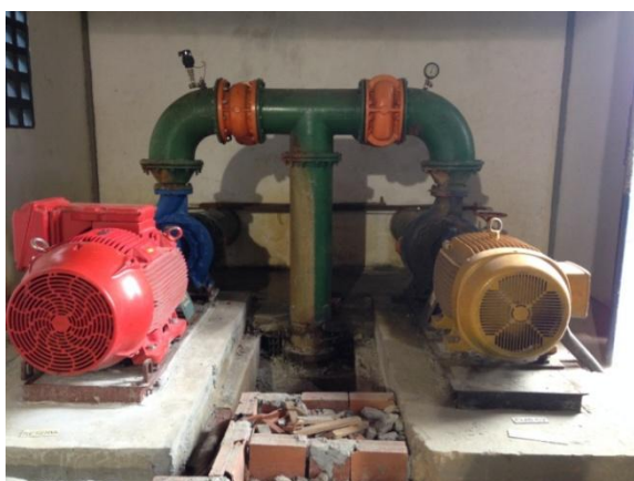
Figura 5.19 - Área interna da casa de bombas da EEAB2
