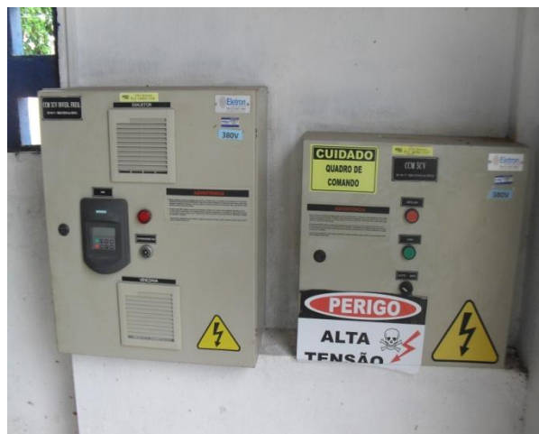
Figura 5.61 - Quadro de comando da EEAT1
