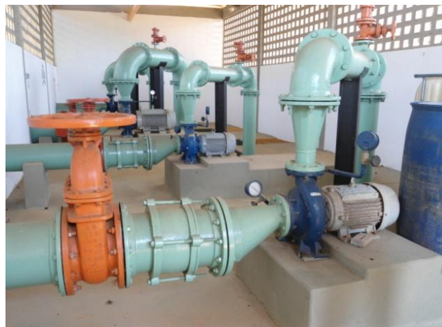
Figura 5.121 – Vista interna da casa de bombas da EET1
