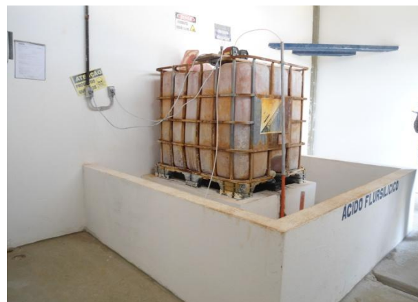
Figura 5.100 – Bombona de ácido fluossilícico diluído, situada no interior da Casa de Química
