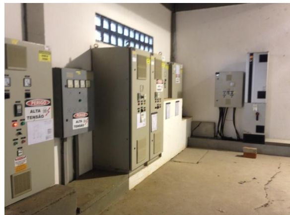
Figura 5.20 - Quadros de comando da EEAB2
