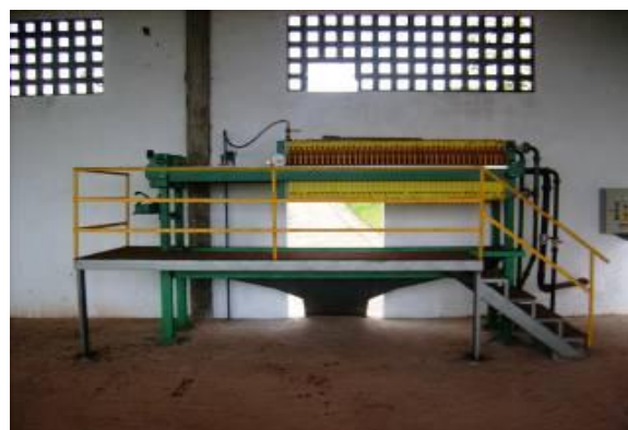
Figura 5.117 – Filtro prensa instalado e inoperante
