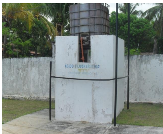
Figura 5.42- Estrutura de apoio da bombona que armazena ácido fluossilícico, externo à Casa de Química
