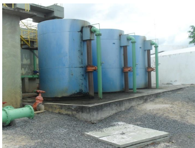
Figura 5.31 - Filtros russos de seção circular (aço carbono)
