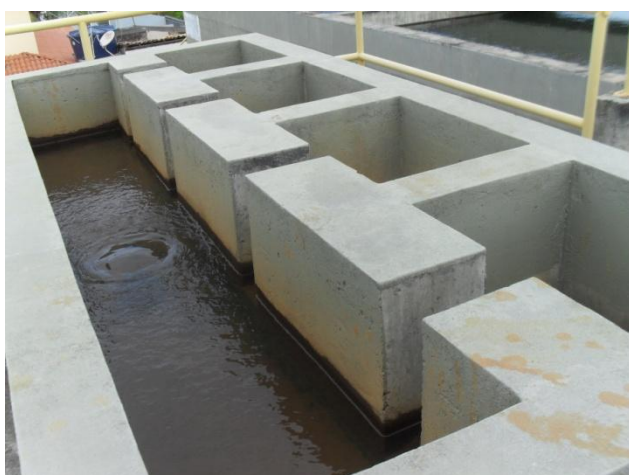
Figura 5.47- Detalhes da Caixa Repartidora de Vazão (CRV)
