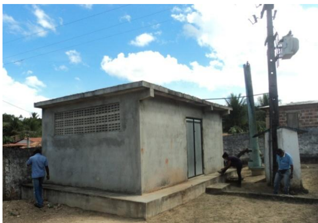
Figura 5.7 – Vista geral da área externa da unidade de tratamento do poço CSB8N
