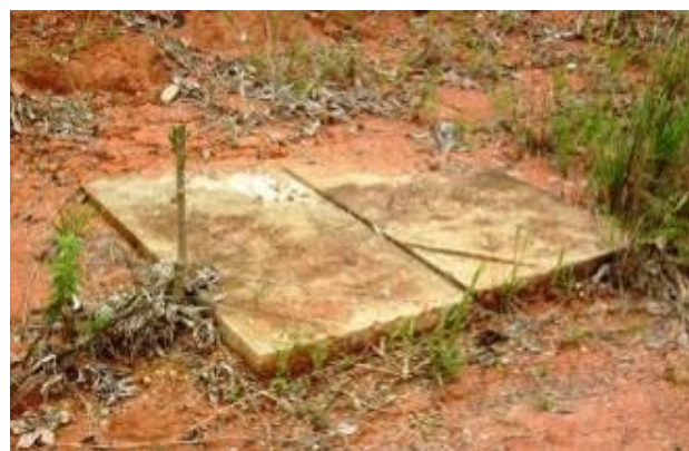
Figura 5.78 – Caixa de ventosa da adutora de água bruta Fonte: EMBASA, 2013.
