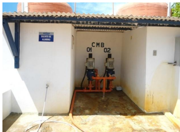
Figura 5.90 – Estação elevatória de transferência do sulfato de alumínio
