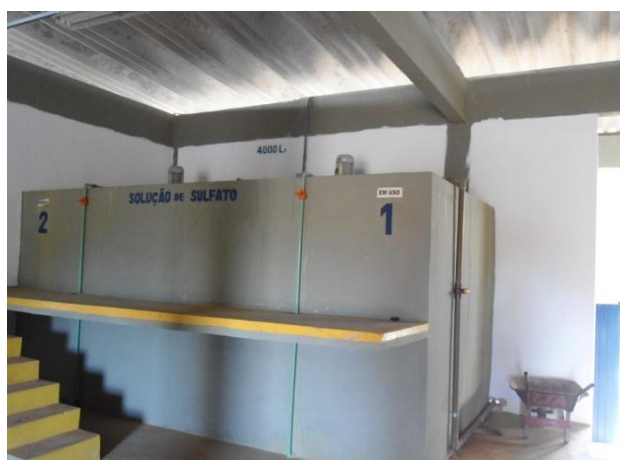
Figura 5.91 – Tanques de preparo da solução de sulfato de alumínio
