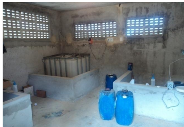
Figura 5.8 – Vista geral da área interna da unidade de tratamento do poço CSB8N
