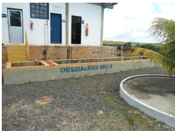
Figura 5.80 – Estrutura de chegada de água bruta
