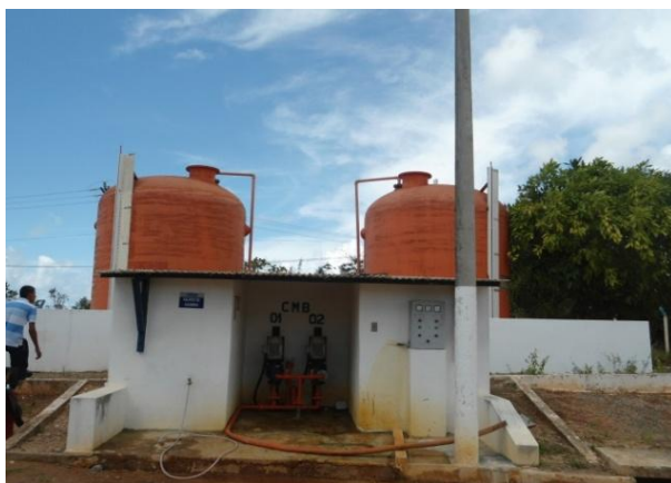
Figura 5.89 – Tanques de sulfato de alumínio ETA do SIAA de Sauípe
