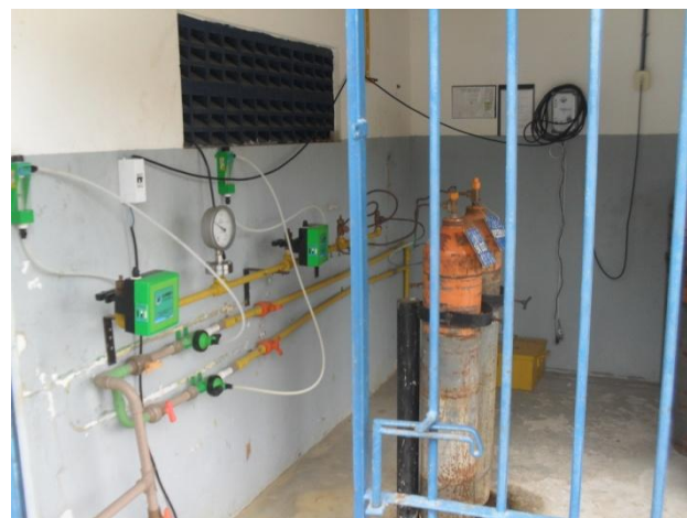
Figura 5.45- Dosadores de cloro e cilindros de 50 kg.
