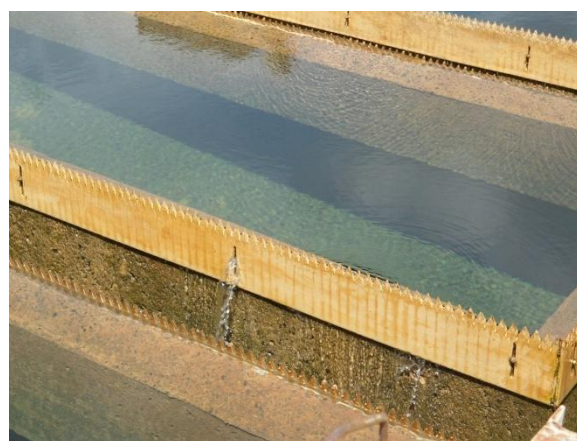
Figura 5.87 – Filtro em operação
