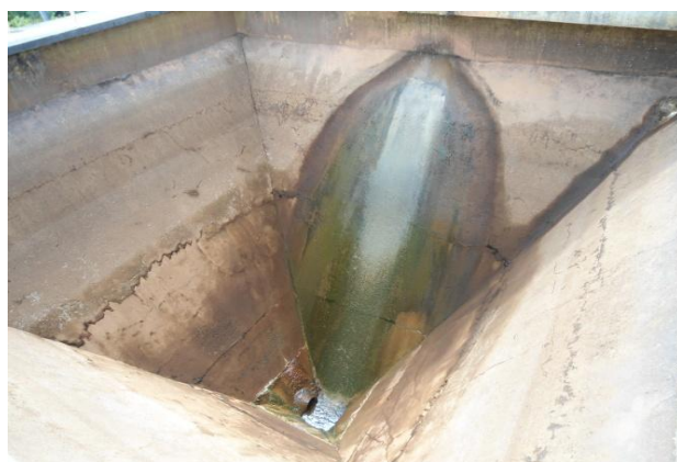
Figura 5.112 – Conformação interna, em forma de tronco de pirâmide, de uma das câmaras do reservatório de coleta de água de lavagem
