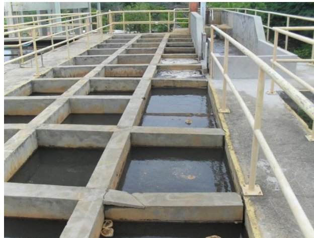
Figura 5.28 - Vista geral do floculador de chicanas verticais
