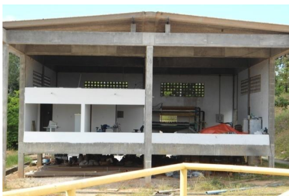
Figura 5.116 – Vista geral do interior da casa de prensagem do lodo
