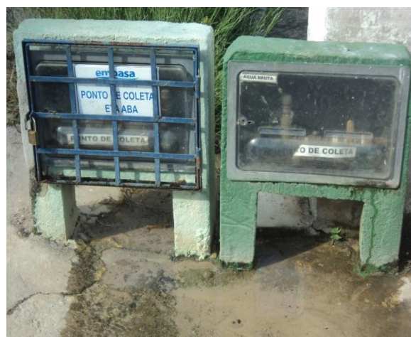
Figura 5.141 – Pontos de coleta para análises físico-químicas da água bruta e água tratada
