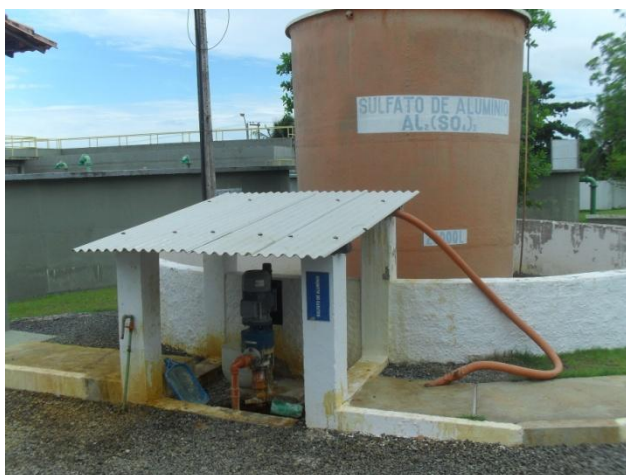
Figura 5.38- Tanque de sulfato de alumínio e bomba dosadora na área externa.
