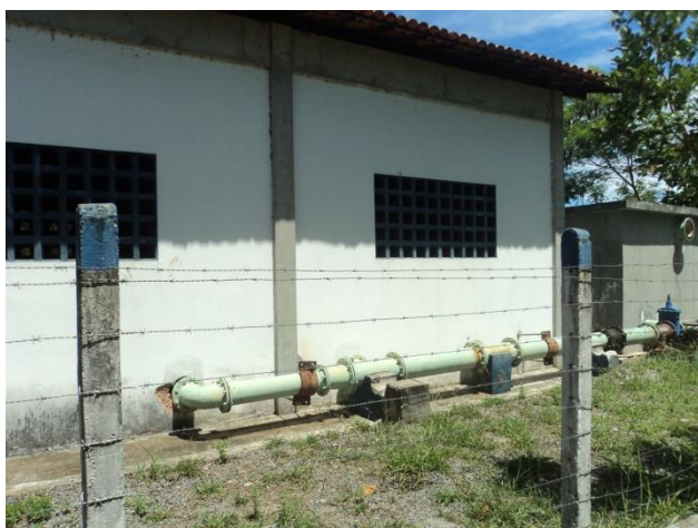
Figura 5.65 - Tubulações de sucção dos conjuntos principais da EEAT2
