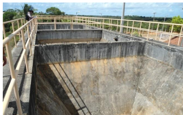
Figura 5.115 – Vista parcial dos reservatórios de armazenamento do lodo
