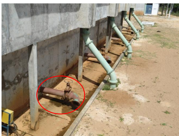
Figura 5.86 – Tubulação de descarga dos filtros, detalhe em vermelho
