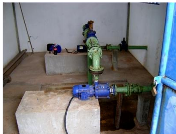
Figura 5.72- Vista interna da EEAT4
