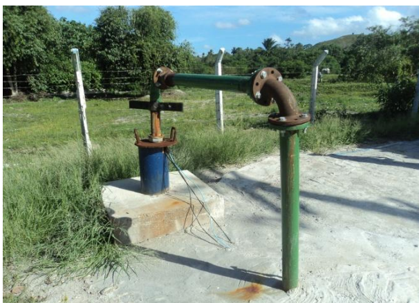
Figura 5.128 – EEB2 – Vista do barrilete de recalque
