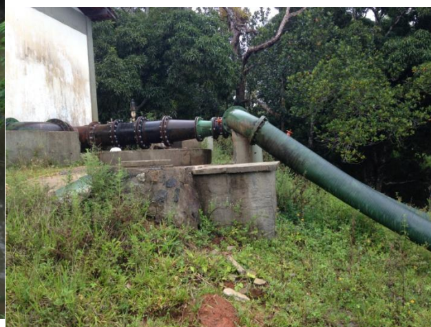
Figura 5.16 - Adutoras de água bruta
