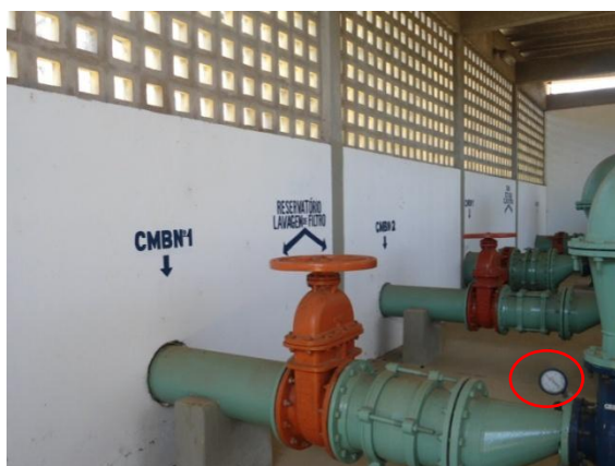
Figura 5.122 – Primeiro sistema de recalque responsável pela alimentação do RAP de 577 m³, com destaque para o medidor de pressão na tubulação de recalque
